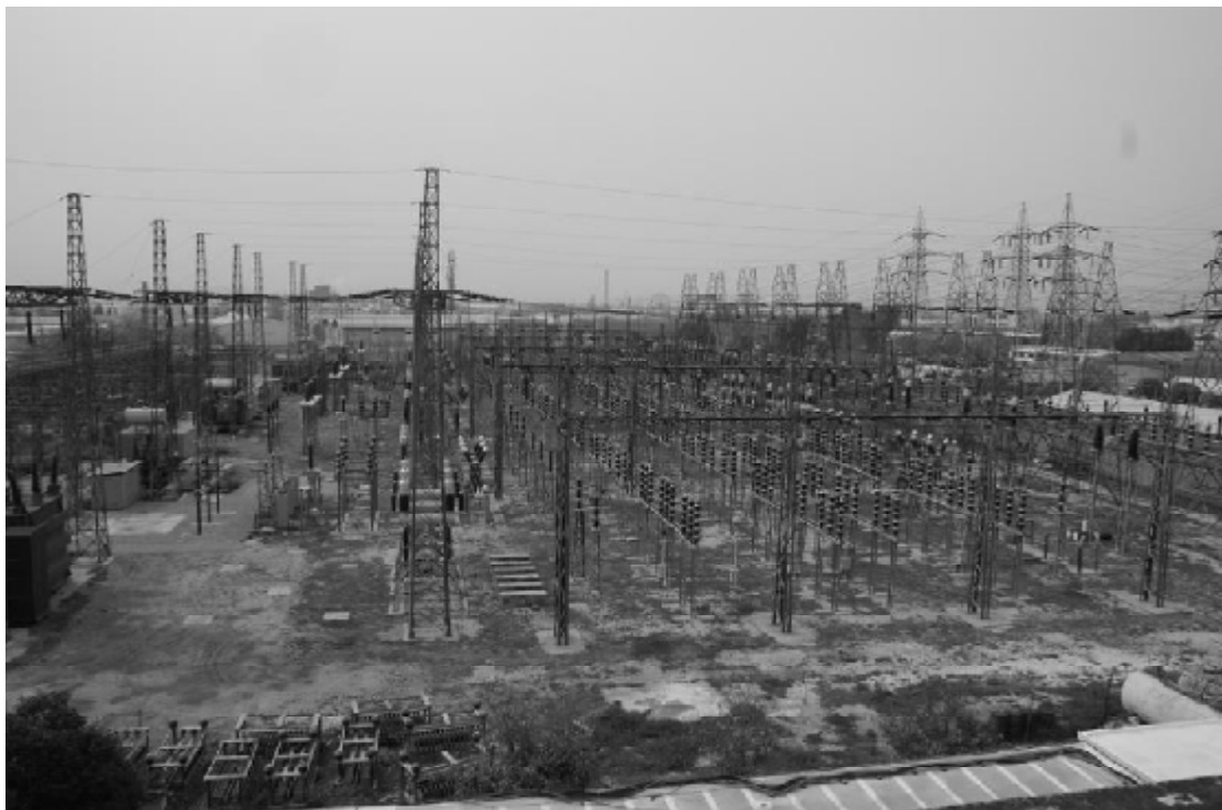
Εικόνα 4.9 Υποσταθμός Ρουφ υποβιβασμού τάσης 150/20 kV
