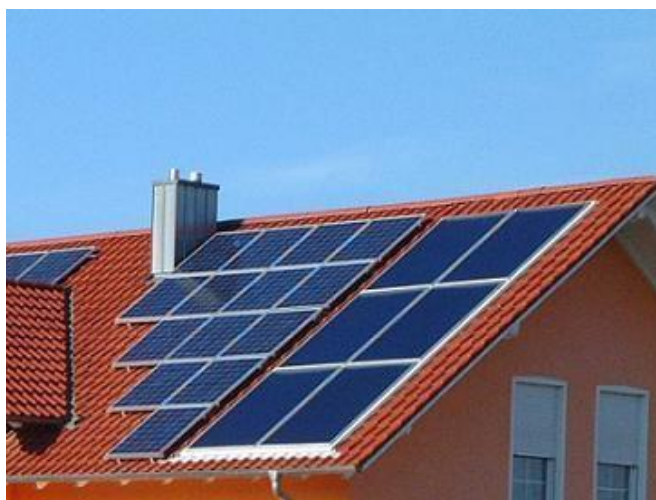
Σχήμα 1.18. Εγκατάσταση οικιακού φωτοβολταϊκού συστήματος.
