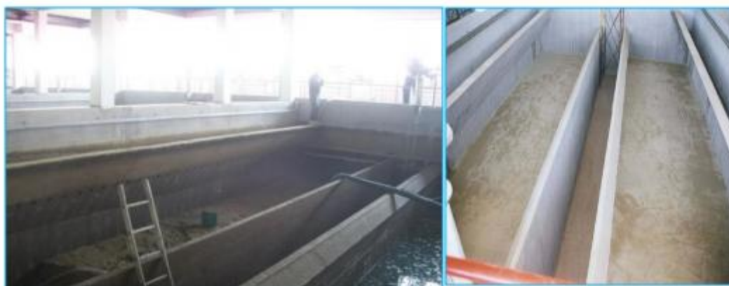
Εικόνα 1: Κλίνες διύλισης νερού στην Ε.Ε.Ν. Θεσσαλονίκης
