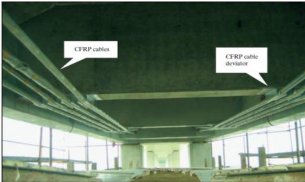
Εικόνα 4.2: Δοκοί με εξωτερική προένταση με χρήση τενόντων από CFRP στη Γέφυρα Heiwei στην επαρχία Huai'an Jiangsu [παρ.142].
