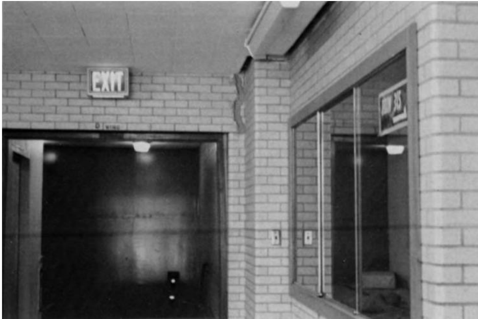
Εικόνα 24: Ρωγμές και διαχωρισμός των τούβλων από την οροφή. [Πηγή: Fu Hua Chen, 1975]
