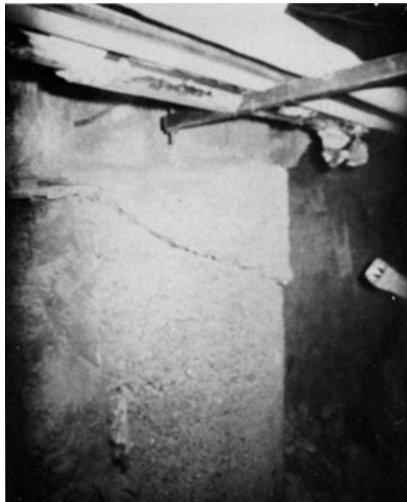
Εικόνα 26: Αστοχία του πασσάλου από διάτμηση αποτέλεσμα της ανύψωσης. [Πηγή: Fu Hua Chen,1975]
