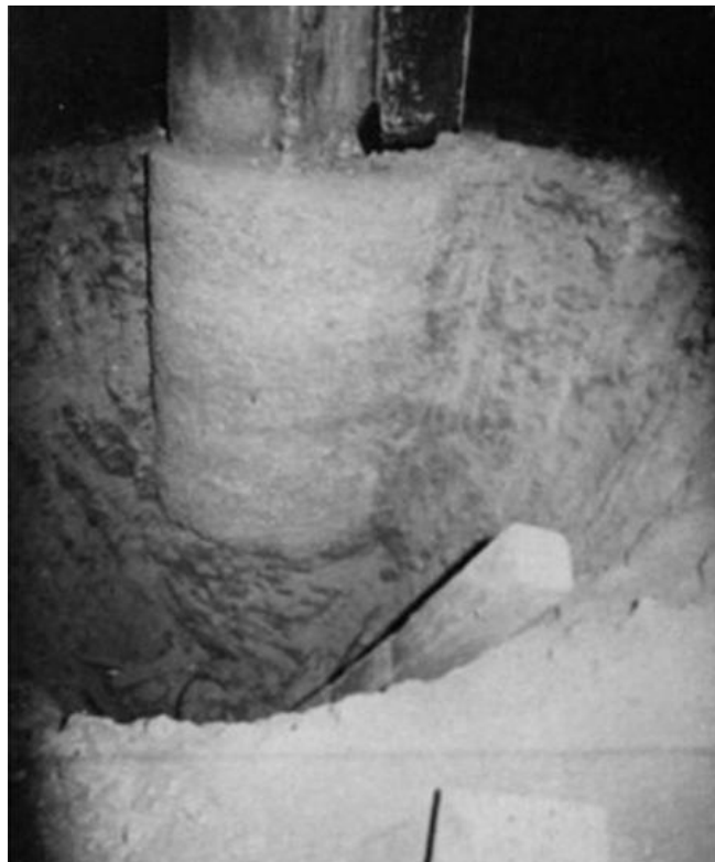
Εικόνα 27: Ακατάλληλη τοποθέτηση πασσάλου. Το μήκος του πασσάλου πρέπει να είναι 20 ft (=6.1 m) και εδρασμένο σε βραχώδες υπόβαθρο. Πραγματικό μήκος μόλις 4 ft (=1.22 m) και εδρασμένο σε άργιλο.
