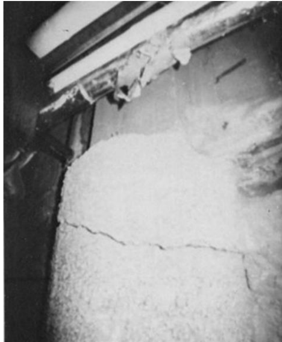
Εικόνα 25: Αστοχία του πασσάλου από διάτμηση αποτέλεσμα της ανύψωσης. [Πηγή: Fu Hua Chen,1975]
