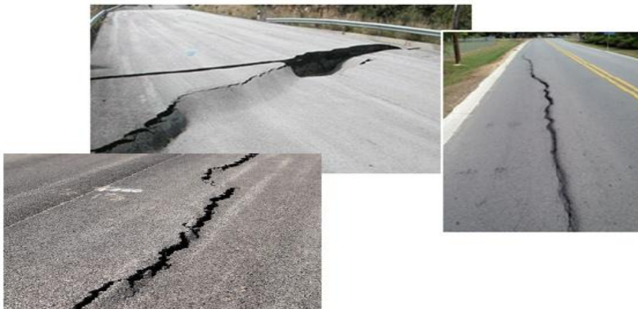
Εικόνα 6: Προβλήματα διόγκωσης εδαφών στο οδόστρωμα [Πηγή: http://www.pavementinteractive.org/article/pumping ]
