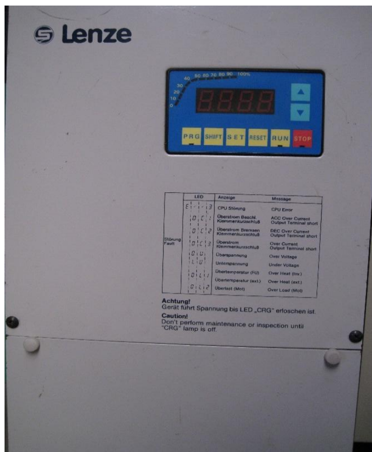
Εικόνα 29: Τριφασικός Inverter 4KW για την ρύθμιση των στρόφων
