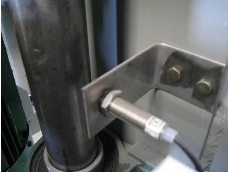
Εικόνα 34: Στροφόμετρο τοποθετημένο στον τελικό άξονα κίνησης
