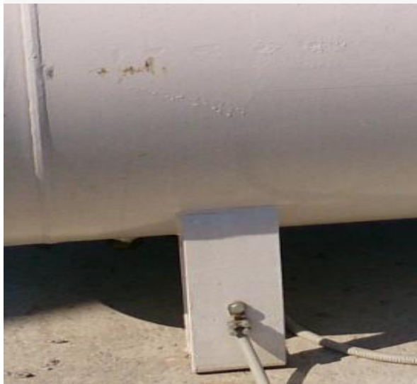
Εικόνα 2.2.4: Σύστημα γείωσης δεξαμενής υγραερίου.
