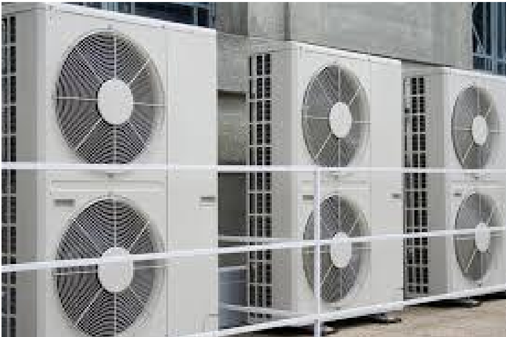
Εικόνα 1.1.: Συγκρότημα κλιματιστικών μονάδων σε κτίριο γραφείων 1
