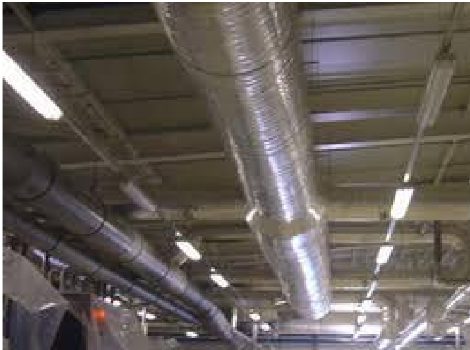
Εικόνα 1.3: Εγκατεστημένοι αεραγωγοί σε βιομηχανικό κτίριο 7
