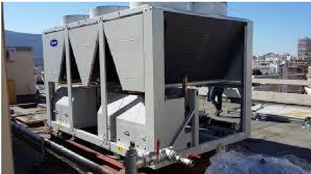
Εικόνα 1.4: Μονάδα αερόψυξης σε ταράτσα επαγγελματικού κτιρίου
