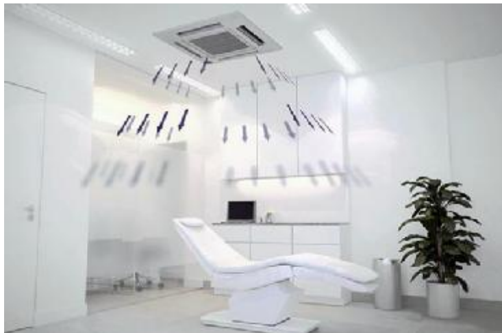
Εικόνα 2.30: Κλιματιστική μονάδα τύπου κασέτας
