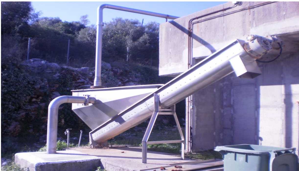
Εικόνα 4.11 Φρεάτιο συγκέντρωσης λιπών
