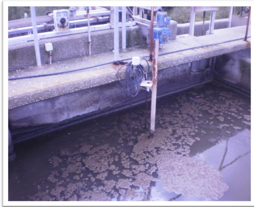
Εικόνα 4.26 Δεξαμενή αποφωσφόρωσης όπου φαίνεται ο υποβρύχιος αναδευτήρας
