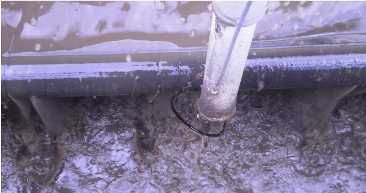
Εικόνα 4.20 Υπερχείλιση δεξαμενής αερισμού
