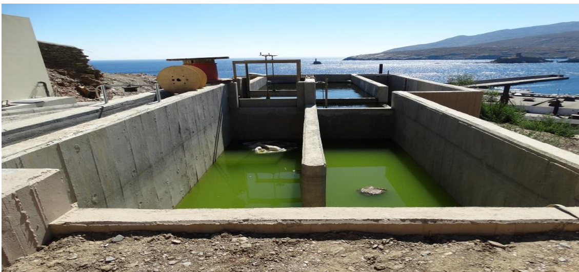
Εικόνα 3.11 Δεξαμενή χλωρίωσης από Ε.Ε.Λ. Σάμου
