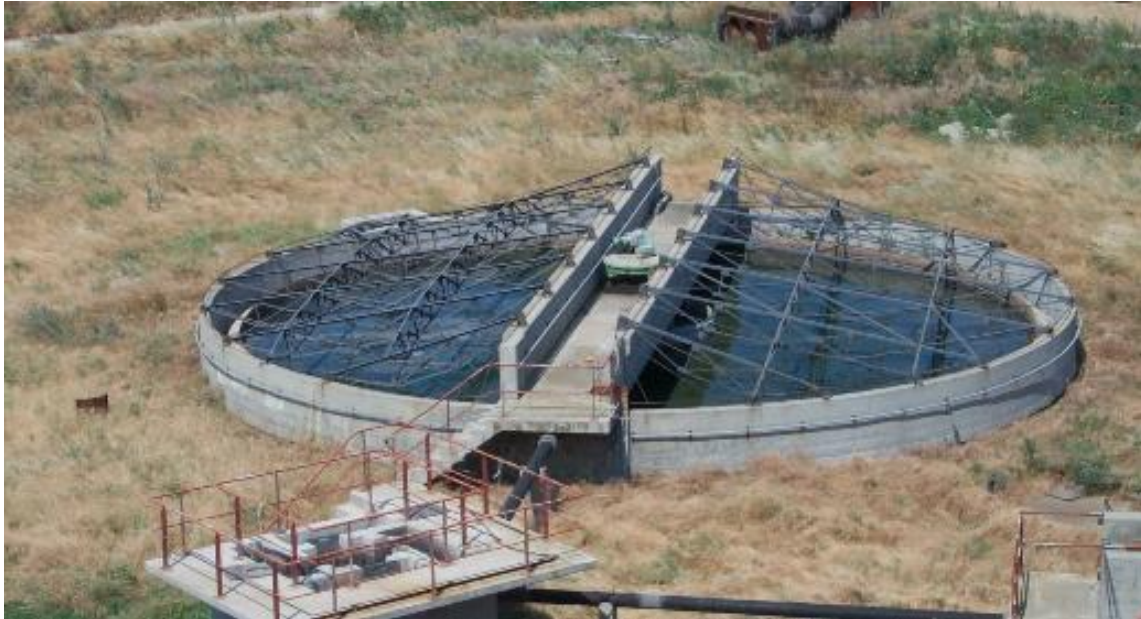
Εικόνα 3.6 Δεξαμενή πάχυνσης με βαρύτητα
