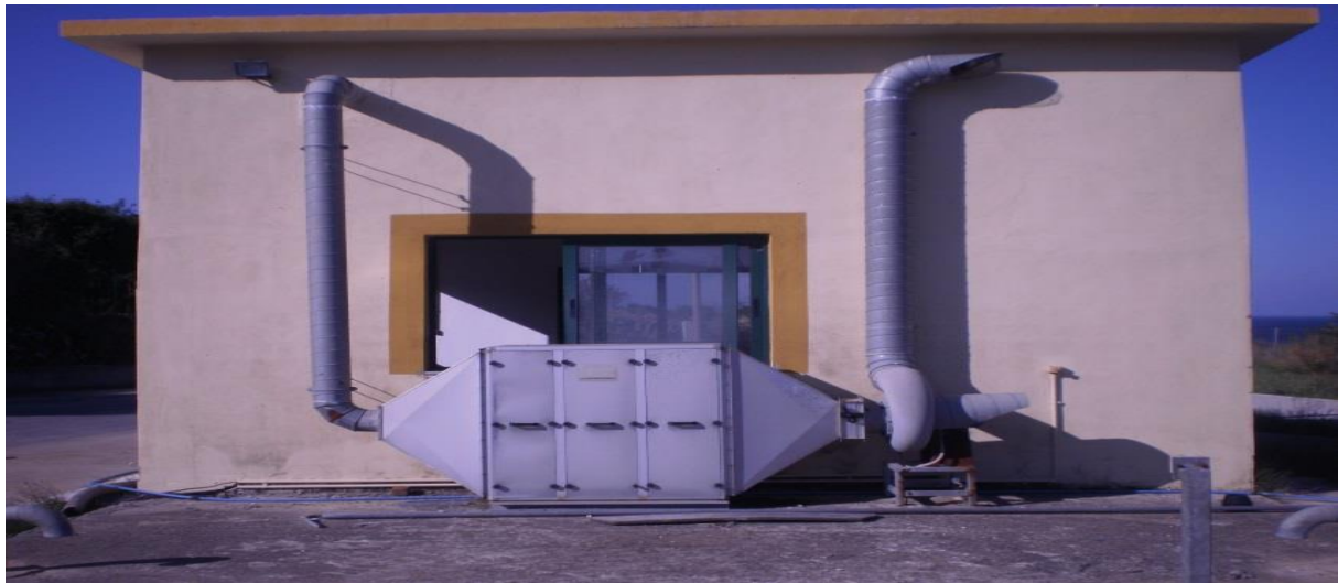
Εικόνα 4.15 Κτίριο βοθρολυμάτων στο οποίο είναι φανερό το σύστημα απόσμησης
