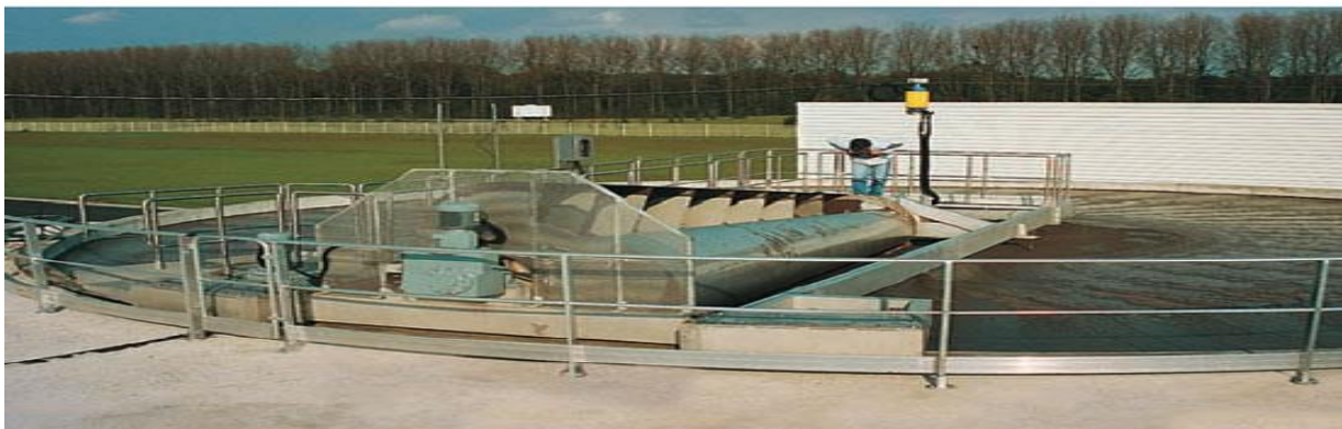
Εικόνα 3.7 Δεξαμενή πάχυνσης με επίπλευση
