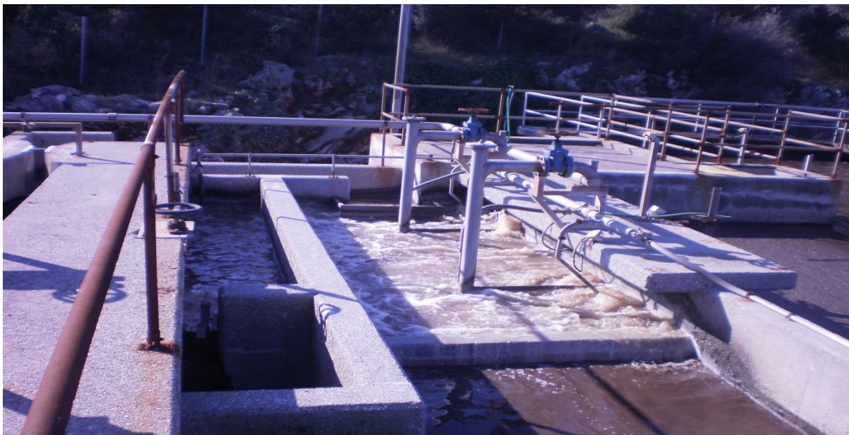
Εικόνα 4.9 Δεξαμενές λιποσυλλογής και αμμοσυλλογής
