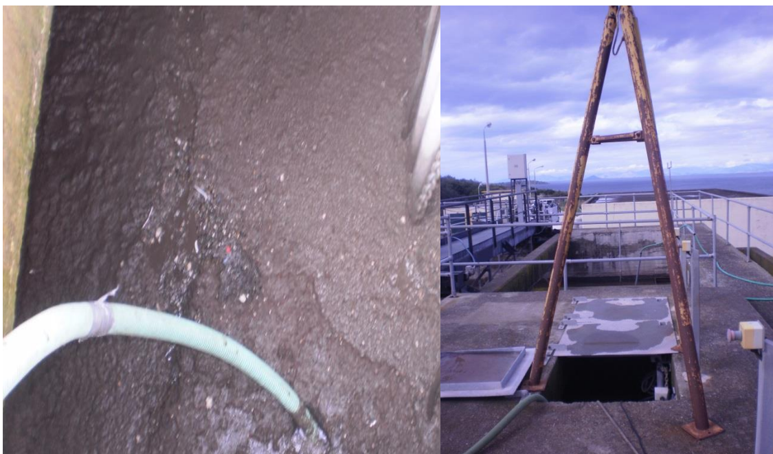
Εικόνα 4.24 Ιλύς στο αντλιοστάσιο ιλύος και αντλιοστάσιο ιλύος της μονάδας
