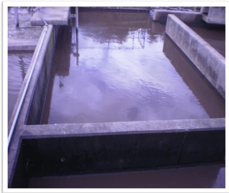
Εικόνα 4.25 Δεξαμενές όπου γίνεται αποφωσφόρωση
