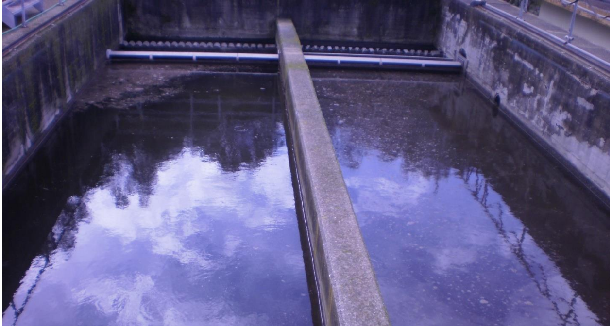
Εικόνα 4.21 Ορθογωνικές δεξαμενές δευτεροβάθμιας καθίζησης
