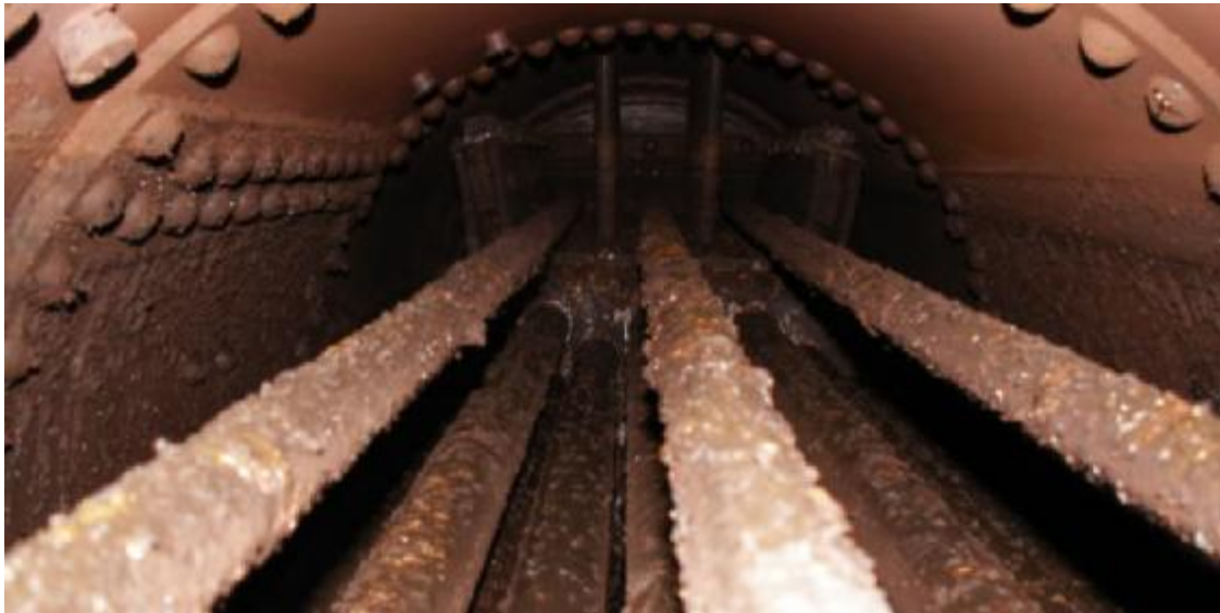
Εικόνα 5: Γαλβανική διάβρωση σε κύκλωμα θέρμανσης 5
