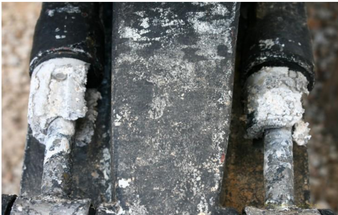
Εικόνα 12: Διάβρωση σε θαλάσσιο περιβάλλον (τμήμα σκάφους) 14
