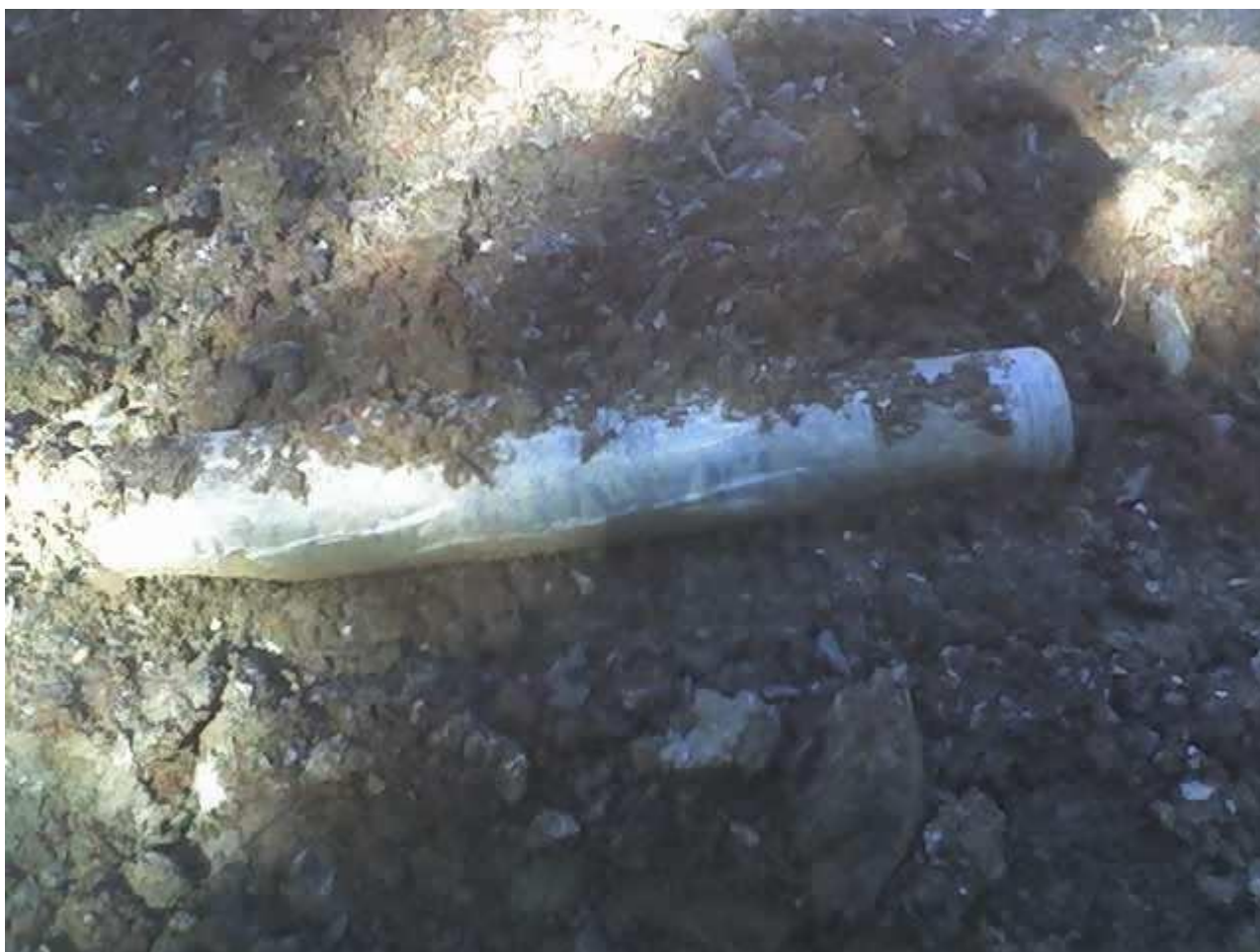
Εικόνα 1. Αγωγός ύδρευσης από αμιαντοτσιμέντο.
