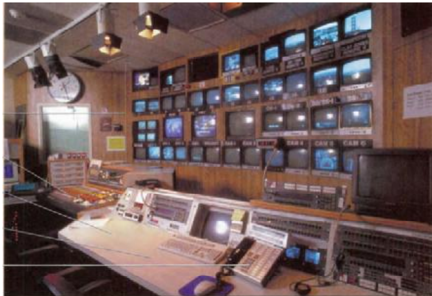
Εικόνα 3-30 Studio control room
