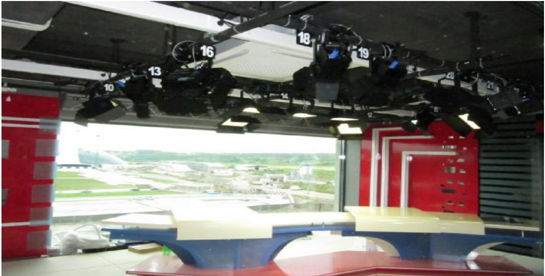
Εικόνα 3-21 Φωτισμός στούντιο (πηγή Herbert)
