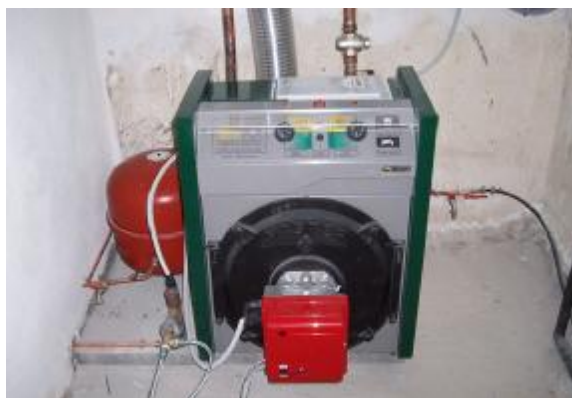
Εικόνα 37-Μονάδα Λέβητα Καυσήρα
