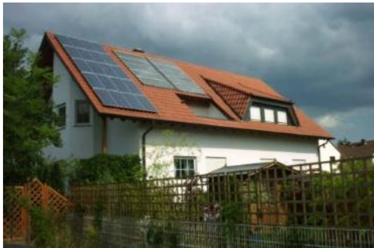
Εικόνα 57-Φωτοβολταϊκή Στέγη σε κατοικία
