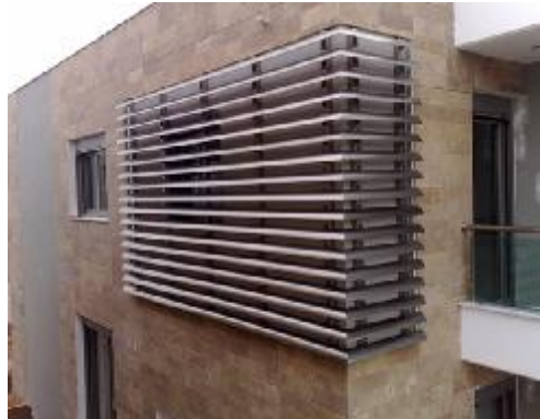
Εικόνα 16-Σταθερό σύστημα οριζόντιας σκίασης σε πρόσοψη κατοικίας
