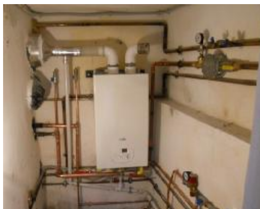
Εικόνα 43-Εγκατάσταση Επίτοιχου Λέβητα Φυσικού Αερίου Τεχνολογίας Συμπύκνωσης
