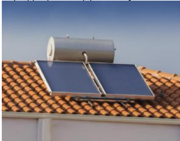
Εικόνα 52-Επίπεδος ηλιακός συλλέκτης τοποθετημένος σε στέγη Κατοικίας
