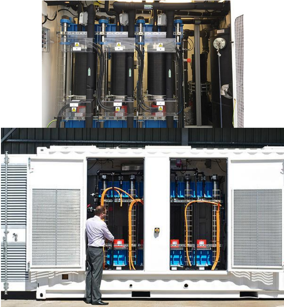
Εικόνα 60. PEM ηλεκτρολύτες στο εσωτερικό ειδικού container (Πηγή: www.surfnturf.org.uk )
