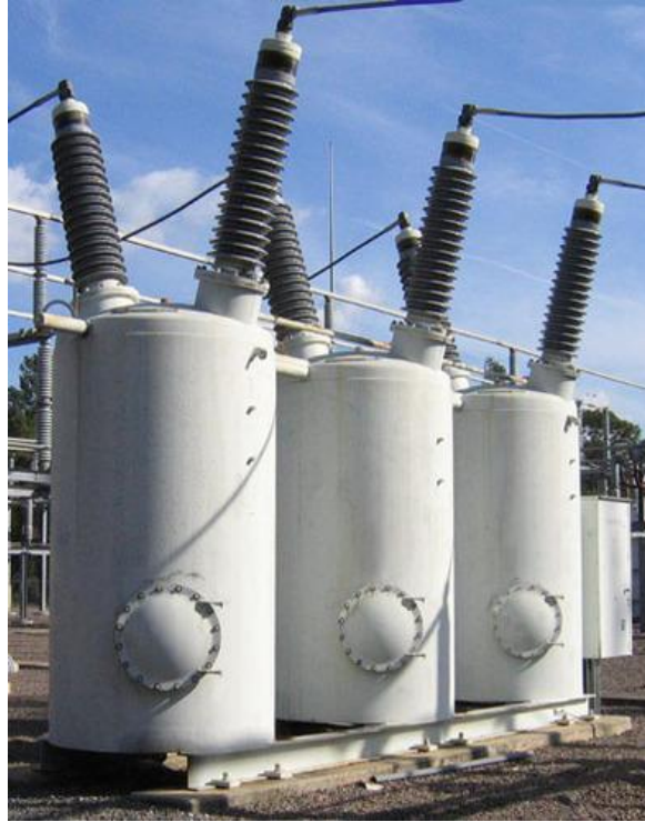
Εικόνα 14: Διακόπτες Ισχύος ελαίου
