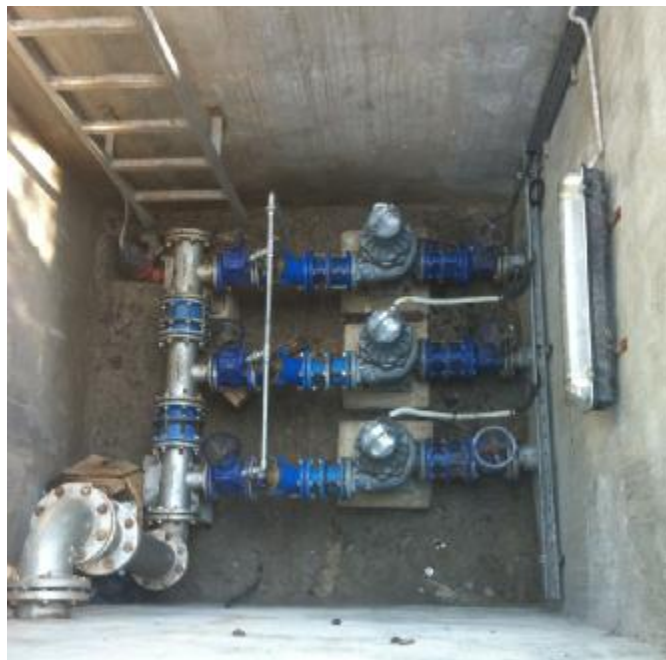
Εικόνα 1: Αντλιοστάσιο με τρεις αντλίες
