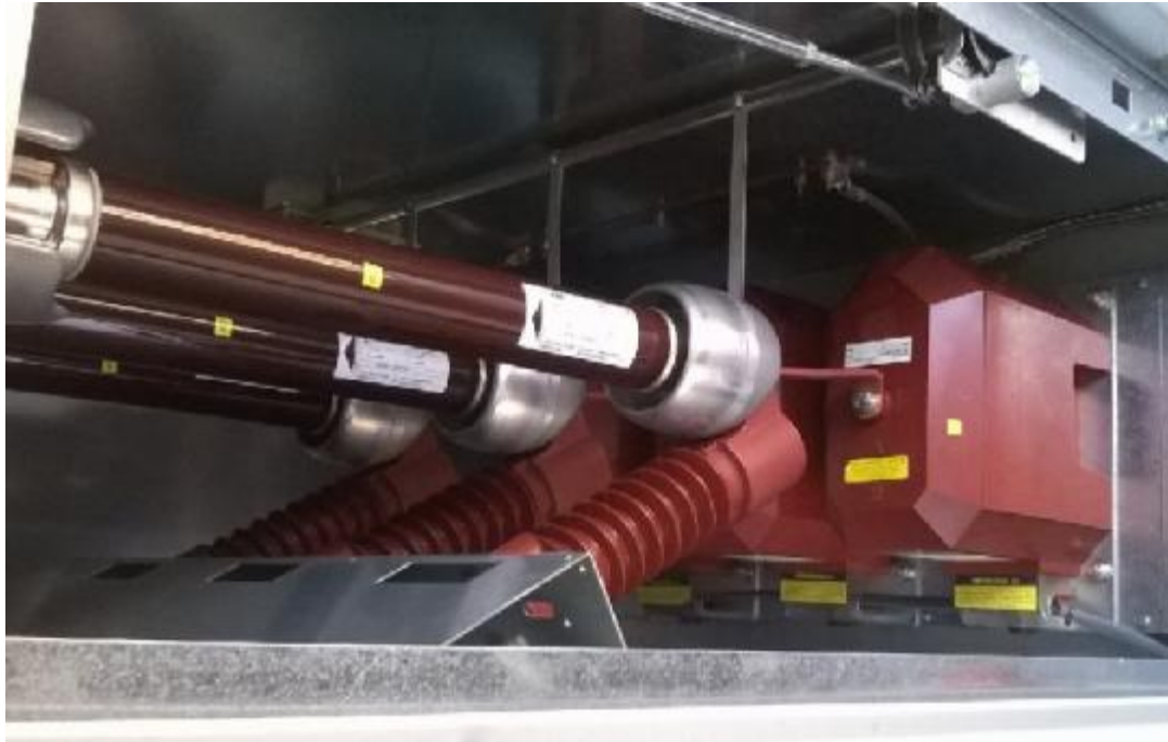
Εικόνα 21: Ασφάλειες Μέσης Τάσης
