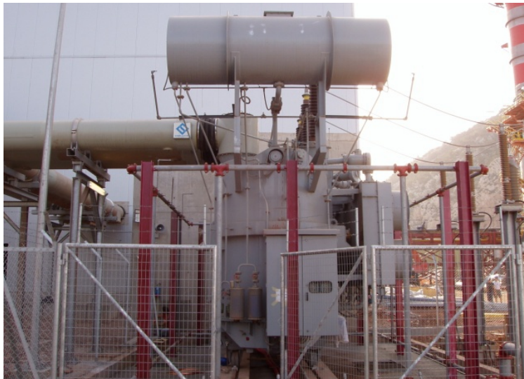
ΕΙΚΟΝΑ 35: Μ/Σ ανυψώσεως γεννήτριας αμμοστροβίλου
