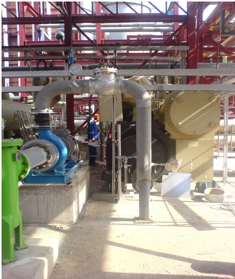
ΕΙΚΟΝΑ 4: Ένα τμήμα του συστήματος ψύξεως αέρος
