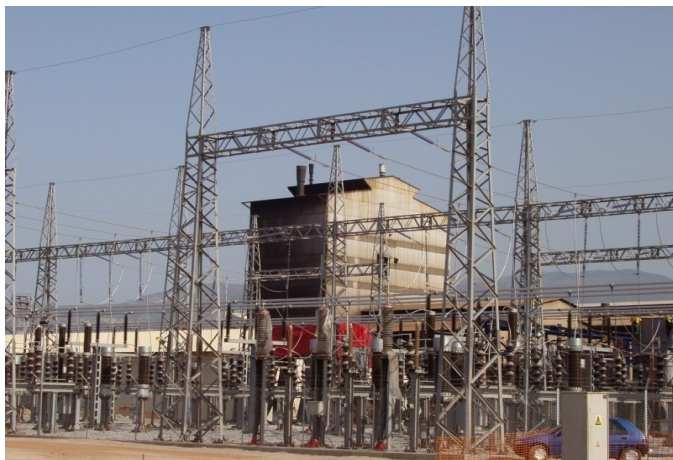
ΕΙΚΟΝΑ 37: Νέος Υποσταθμός
