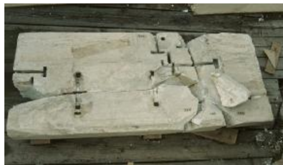
Διόγκωση μέλους λόγω οξείδωσης των συνδέσμων
