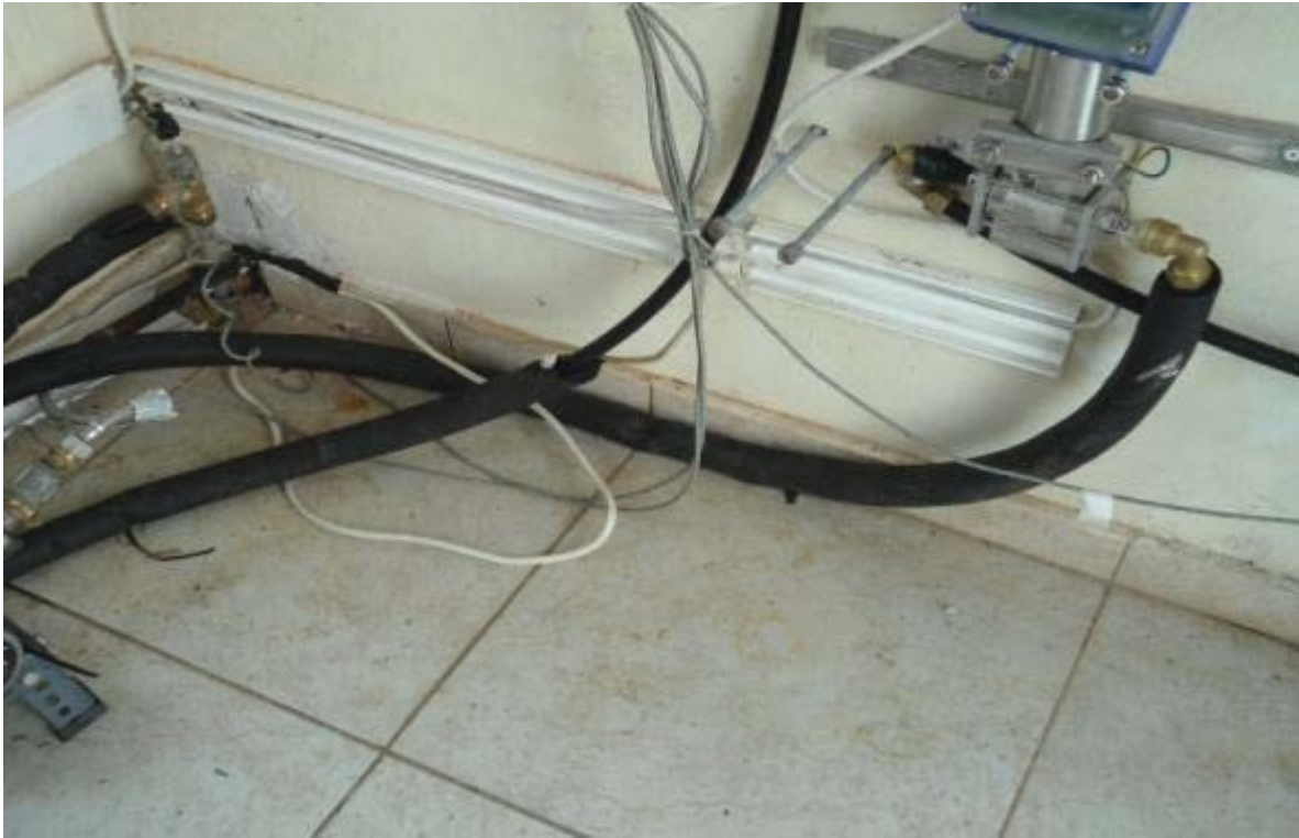
Εικόνα 4.42: Σύνδεση ροόμετρου πριν την είσοδο για την ενδοδαπέδια θέρμανση
