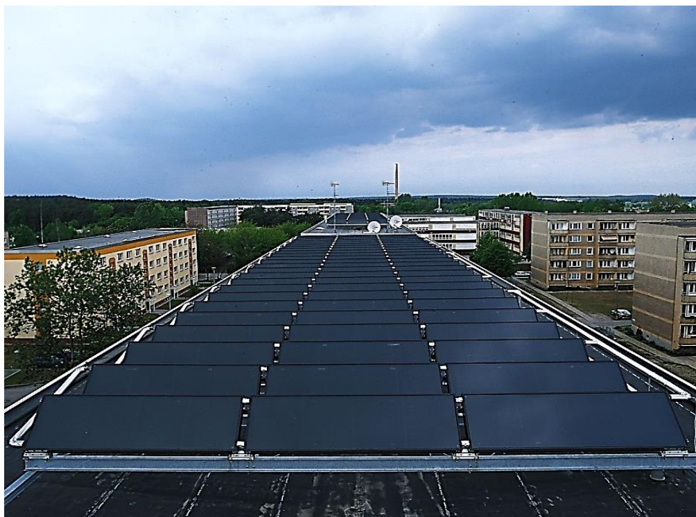
Εικόνα 3.2: Ηλιακοί συλλέκτες συνδεδεμένοι σε οροφή συγκροτήματος γραφείων
