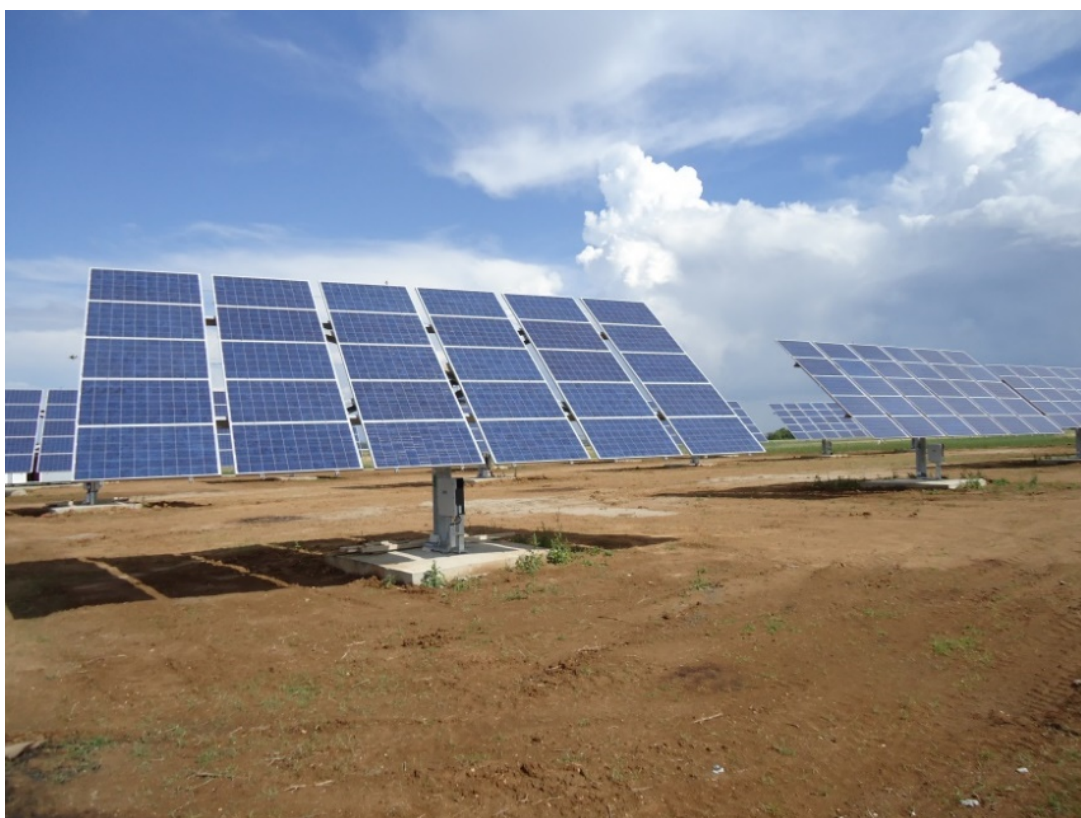
Εικόνα 2.43: Φ/Β Σύστημα σε τράκερ
