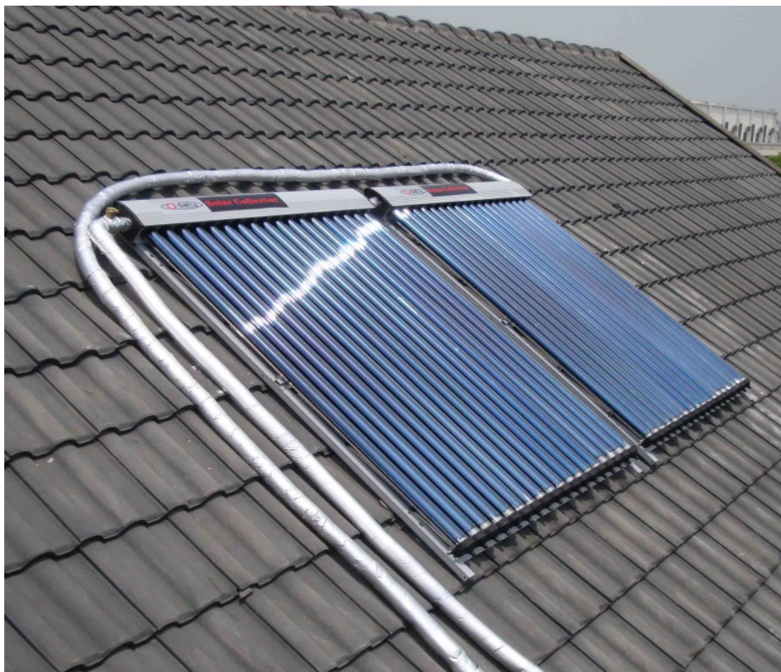
Εικόνα 3.12: Ηλιακοί Συλλέκτες κενού σε στέγη κατοικίας
