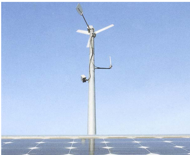
Εικόνα 2.1: Συνδυασμός ανεμογεννήτριας και PV πλαισίων για κάλυψη των ηλεκτρικών φορτίων.
