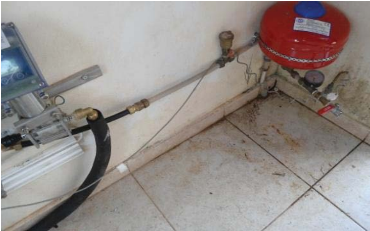
Εικόνα 4.43: Είσοδος ενδοδαπέδιας και δοχείο διαστολής
