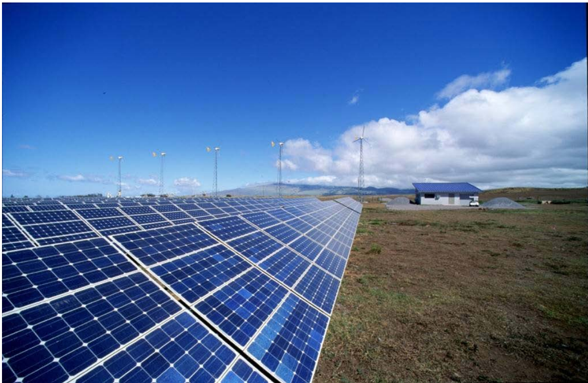
Εικόνα 2.32: Πάνελ σε διασυνδεδεμένο φ/β σύστημα σε πάρκο 41
