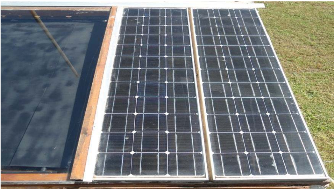
Εικόνα 5.23 : Εγκατεστημένα φωτοβολταϊκά πλαίσια στην στέγη του οικίσκου
