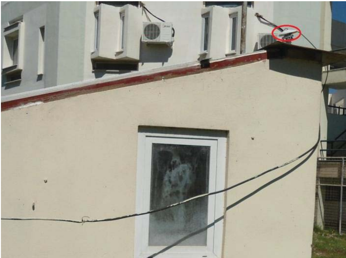
Εικόνα 5.32: Πυρανόμετρο οικίσκου δοκιμών στο επίπεδο της στέγης του Εργαστηρίου ΑΠΕ ΤΕΙ Δυτικής Ελλάδας
