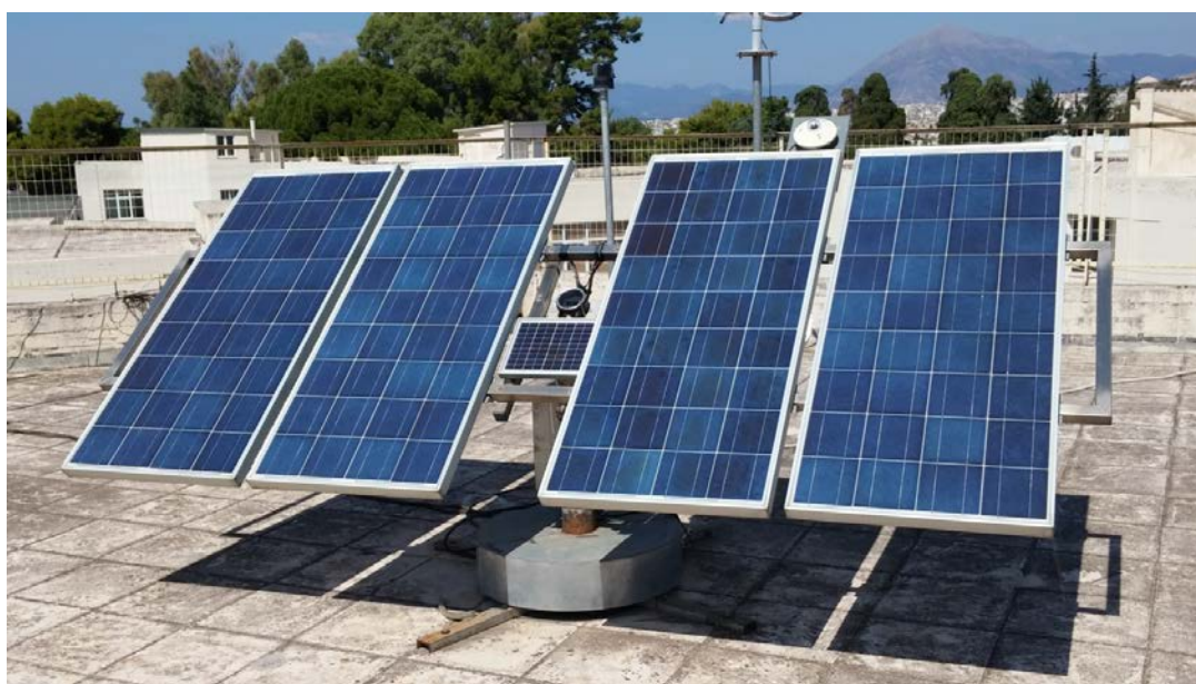
Εικόνα 2.42: Φ/β πλαίσιο σε τράκερ ενός άξονα (κτίριο ΑΠΕ στο ΤΕΙ δυτικής Ελλάδος)
