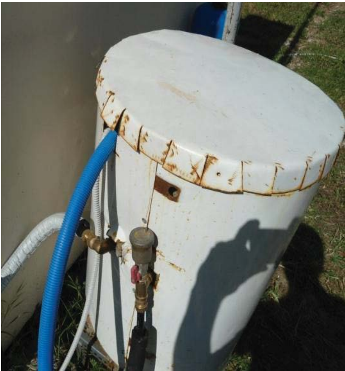
Εικόνα 4.37: δεξαμενή αποθήκευσης ZNX
