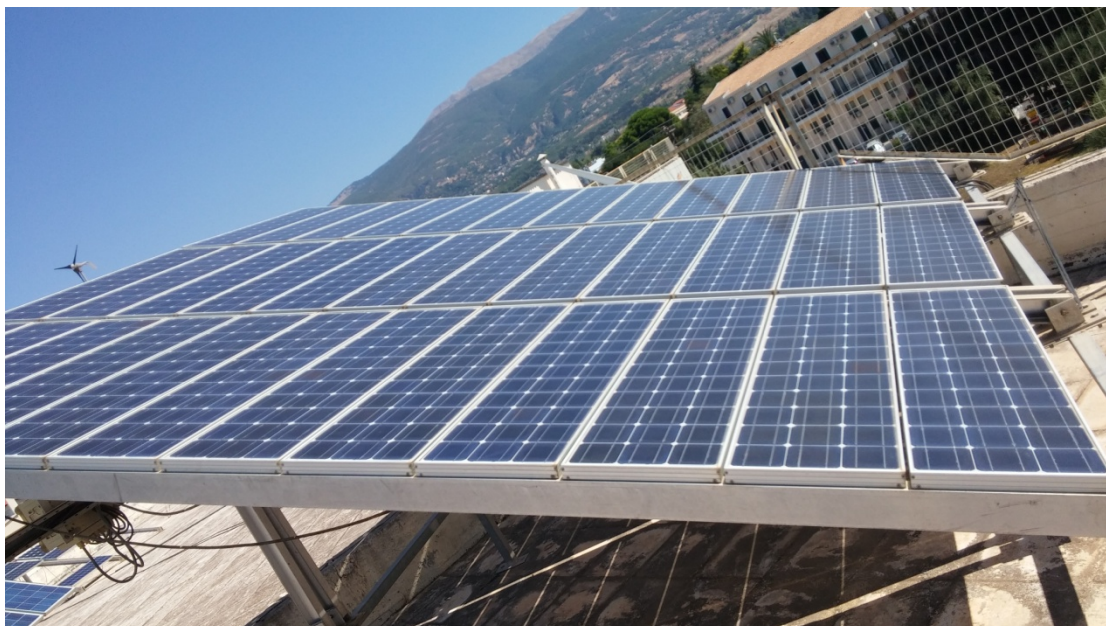
Εικόνα 2.39: Φ/β γεννήτρια σε στέγη εργαστήριο ΑΠΕ του ΤΕΙ Δυτικής Ελλάδας
