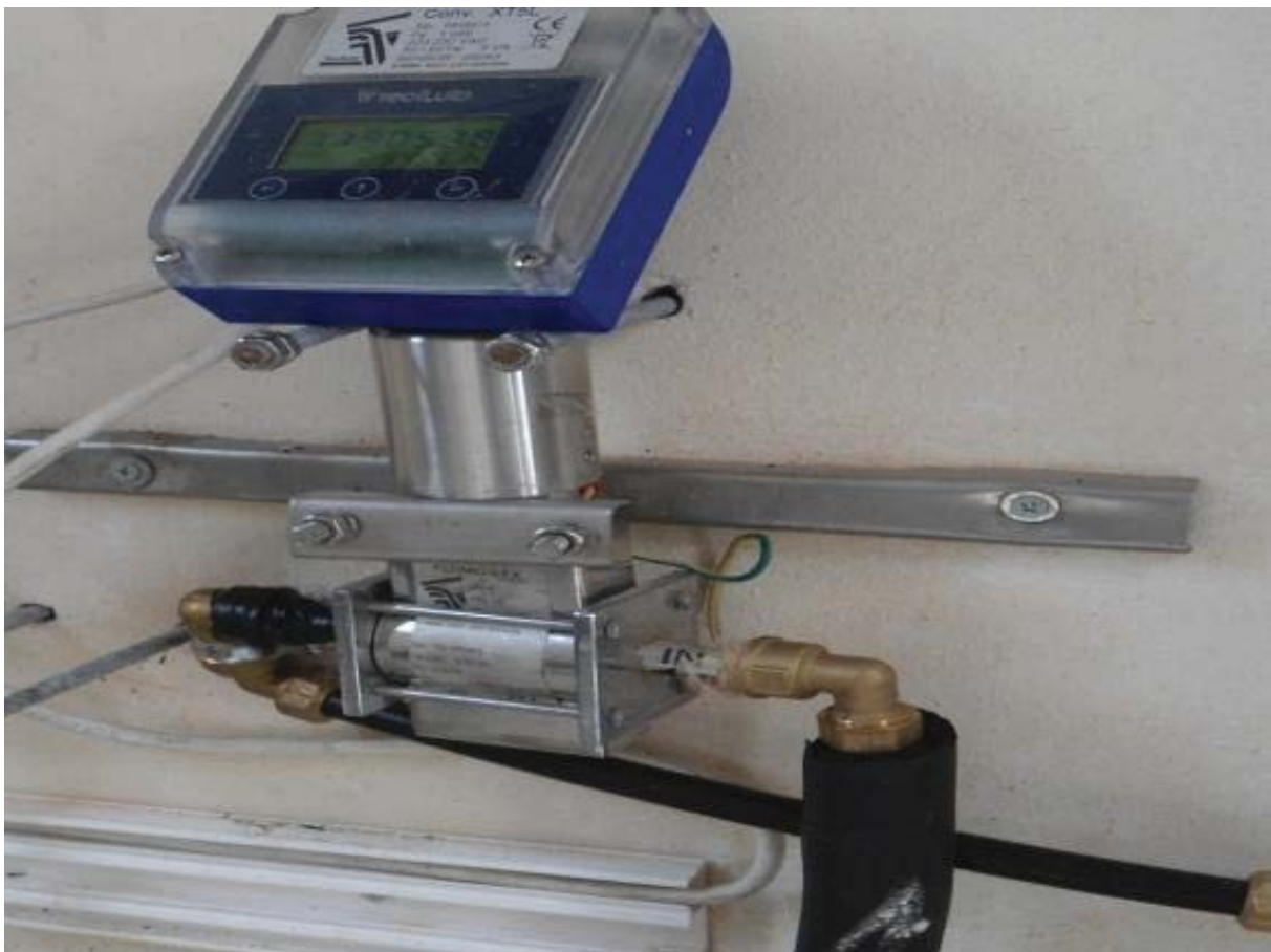
Εικόνα 4.41: ροόμετρο κυκλώματος ενδοδαπέδιας θέρμανσης οικίσκου
