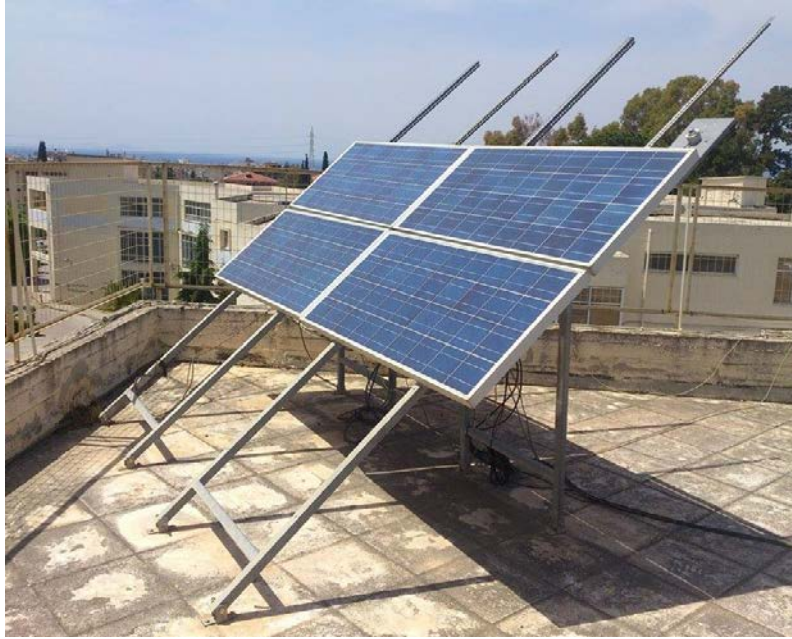
Εικόνα 2.37: Φωτοβολταϊκή γεννήτρια με σταθερή κλίση (Fixed) στο εργαστήριο ΑΠΕ, ΤΕΙ Δυτικής Ελλάδας
