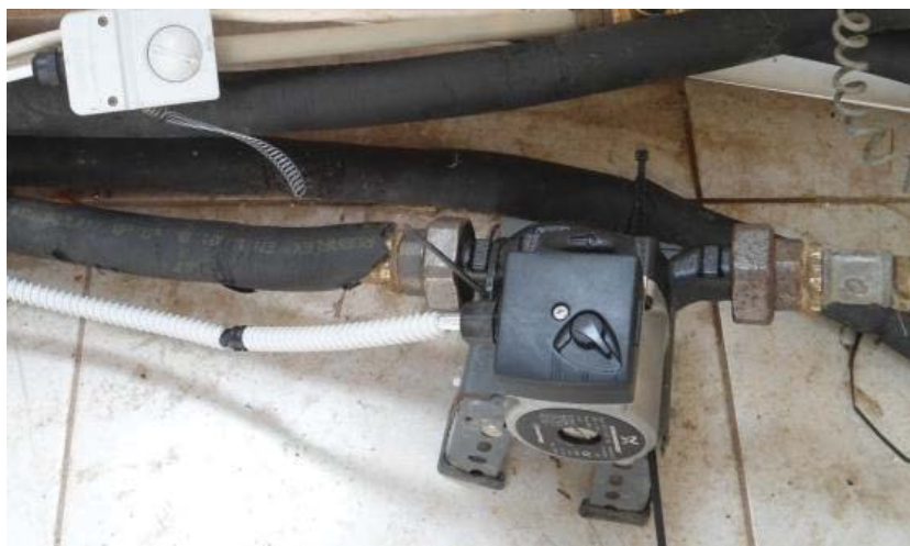
Εικόνα 4.38: Κυκλοφορητής GRUNDFOS συστήματος θέρμανσης από ηλιακούς συλλέκτες
