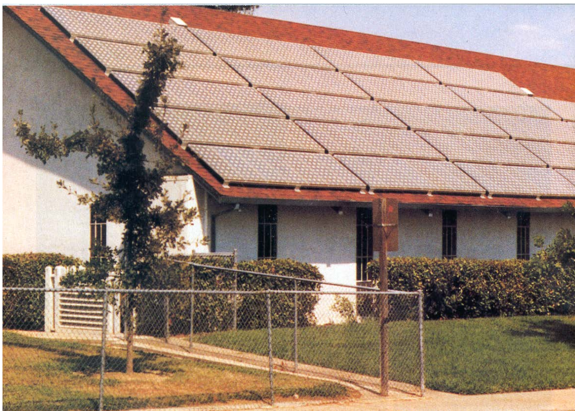
Εικόνα 2.4: Εγκατάσταση PV πλαισίων σε στέγη για αυτοδύναμη κάλυψη των ενεργειακών αναγκών (ηλεκτρικά φορτία).
