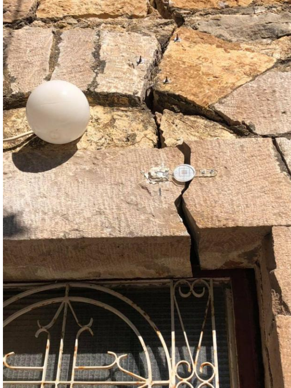
Εικόνα 4.15: Ρωγμή που υπάρχει στην κεντρική είσοδο στον Ναό
