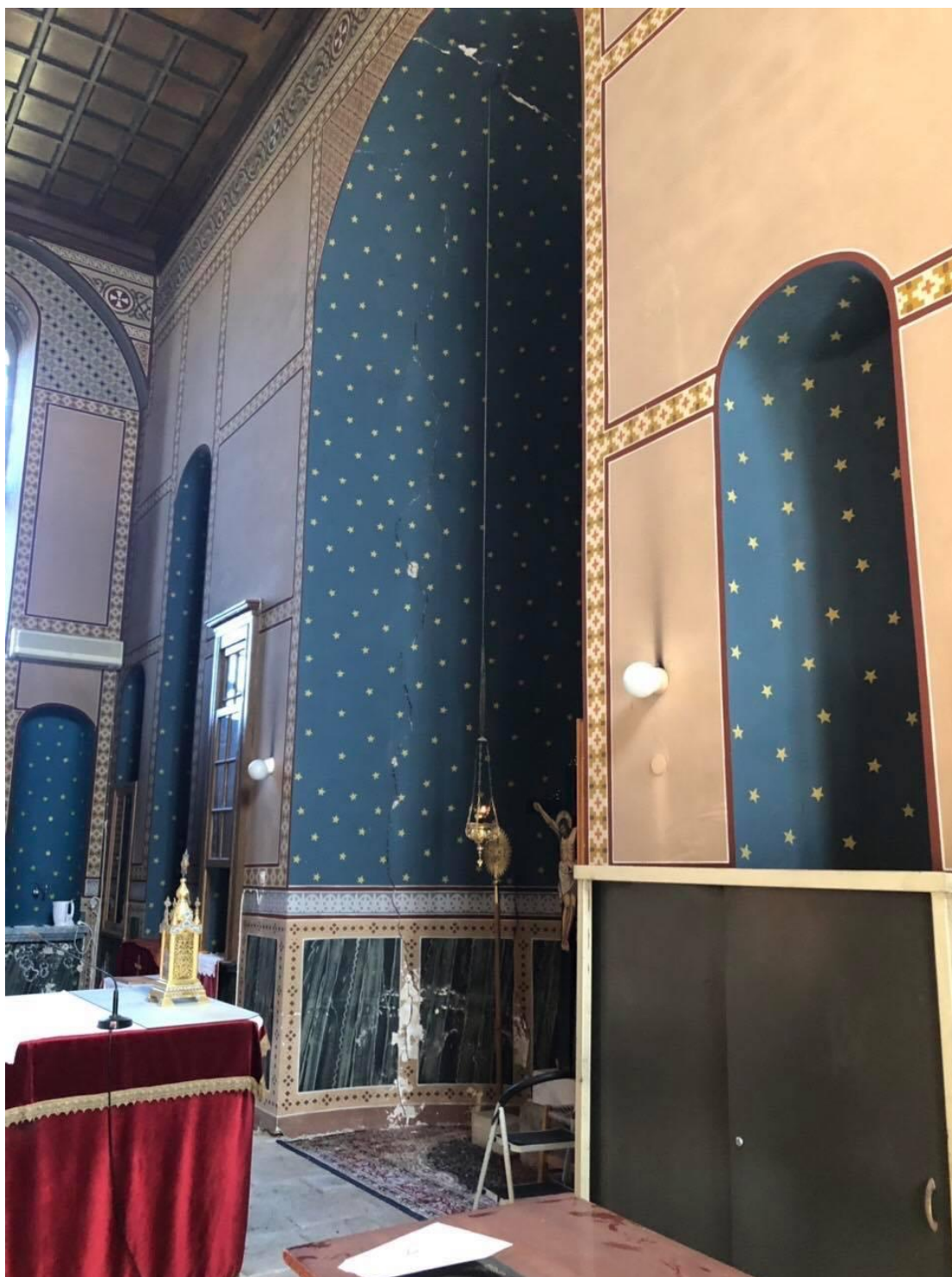
Εικόνα 4.27: Αστοχία που έχει δημιουργηθεί κοντά στο ιερό
