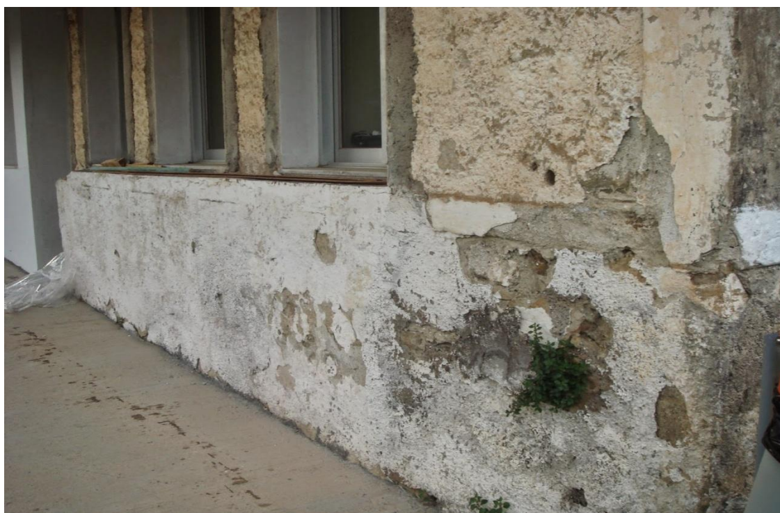
Εικόνα 1.9: Ρωγμές που δημιουργήθηκαν στο εξωτερικό του σχολείου
