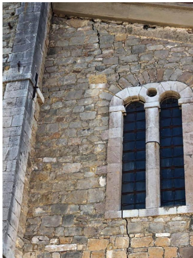
Εικόνα 4.16: Ρωγμή που υπάρχει σε παράθυρο της εκκλησίας
