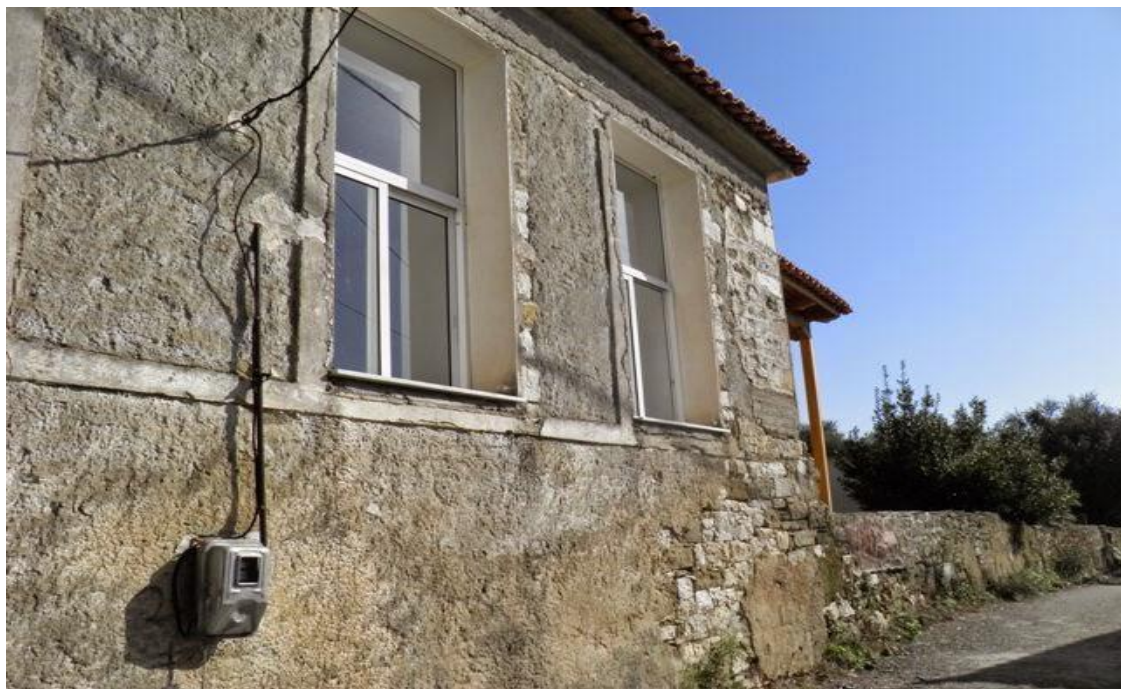
Εικόνα 1.8: Ρωγμές που δημιουργήθηκαν στο εξωτερικό του σχολείου
