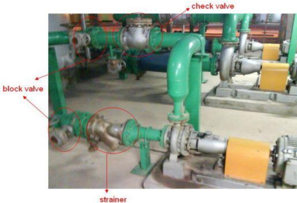
Εικόνα 3.19. Στην παραπάνω εικόνα φαίνεται μια φυγοκεντρική αντλία και σχεδόν όλοι οι τύποι αντλιών που βρίσκονται στο διυλιστήριο έχουν παρόμοια διάταξη 41
