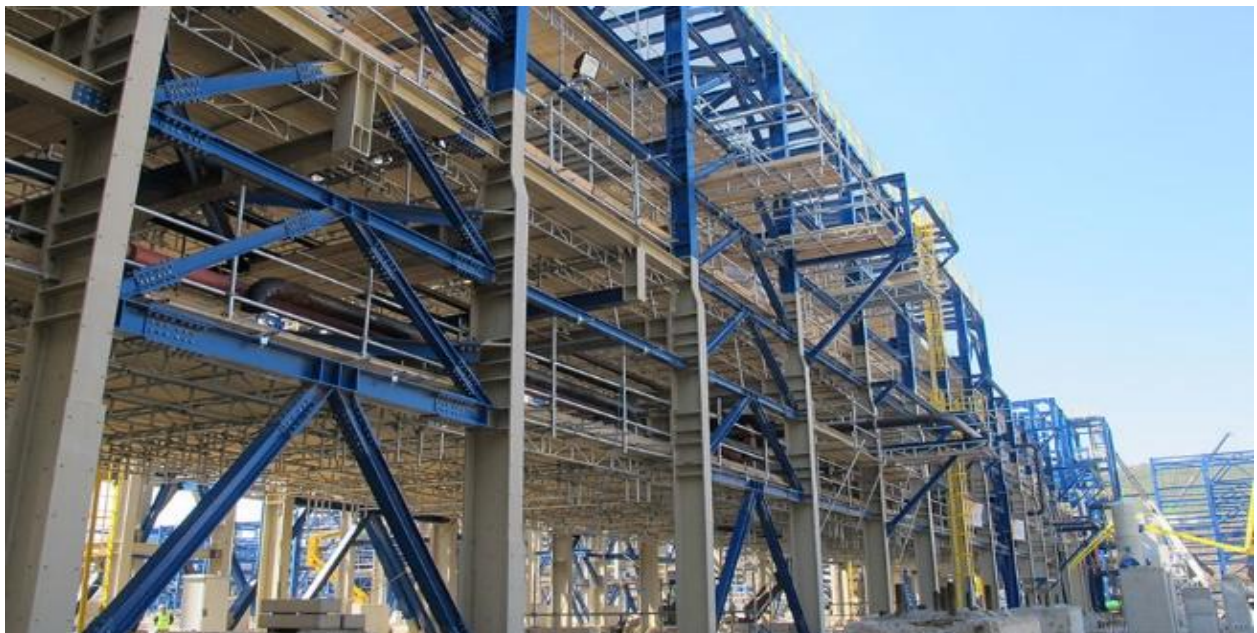
Εικόνα 3.1. Εικόνα από pipe rack κεντρικού σωληνοδιάδρομου σε διυλιστήριο 22
