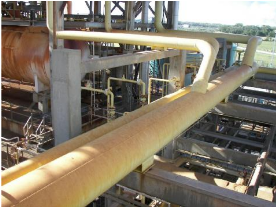
Εικόνα 3.7. Στην εικόνα φαίνεται ο τρόπος σύνδεσης στα συστήματα πυρσού (flare connection lines) 29
