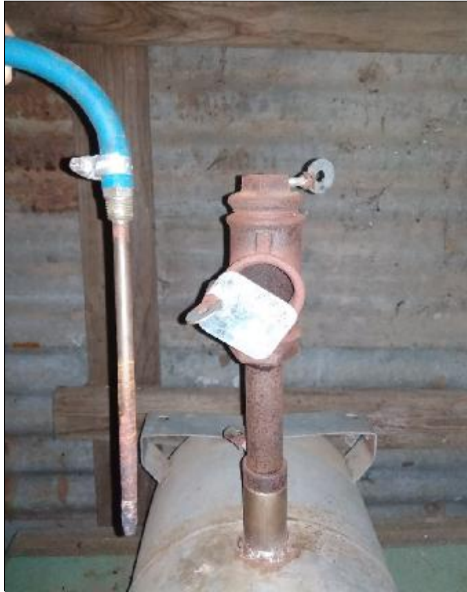
Εικόνα 98: Χειροποίητο μπεκ στα αριστερά συνδεδεμένο με την παροχή προπανίου και η κατασκευή εισαγωγής του οξυγόνου για την καύση, τοποθετημένη στο κεντρικό θάλαμο.
