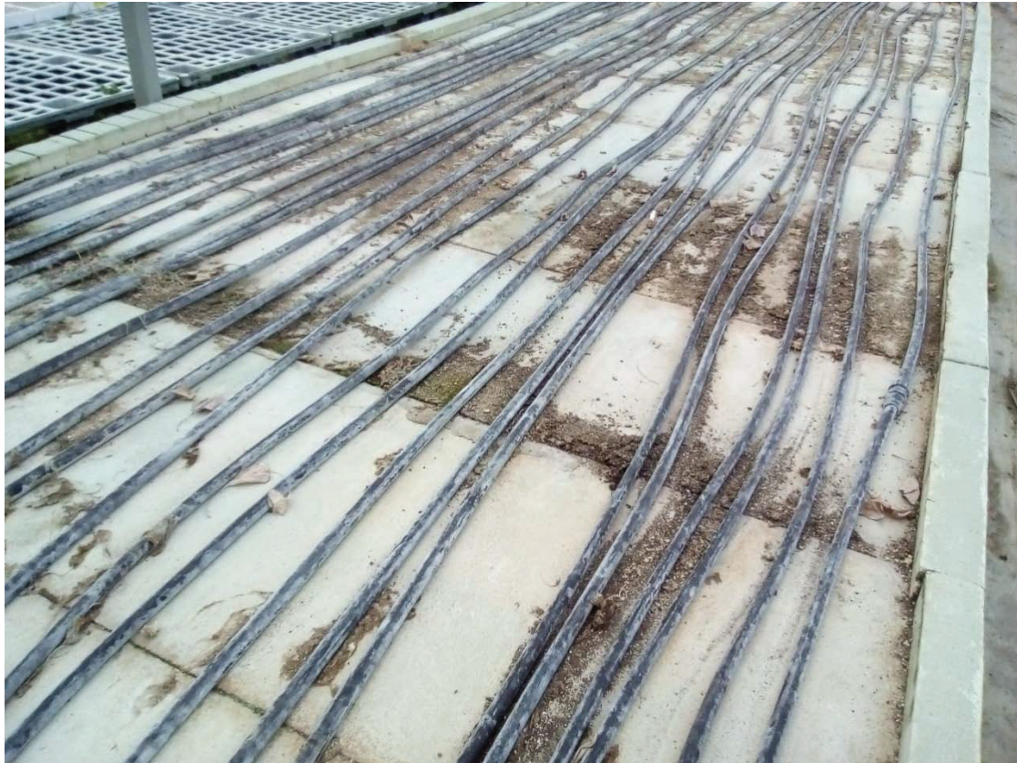
Εικόνα 15. Σωληνώσεις συστήματος θέρμανσης θερμοκηπίου πάνω σε κλίνες.
