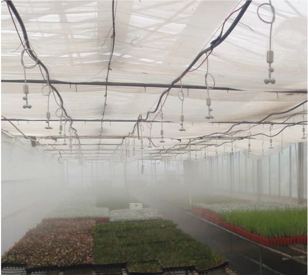
Εικόνα 20. Σύστημα υδρονέφωσης σε πλήρη λειτουργία.
