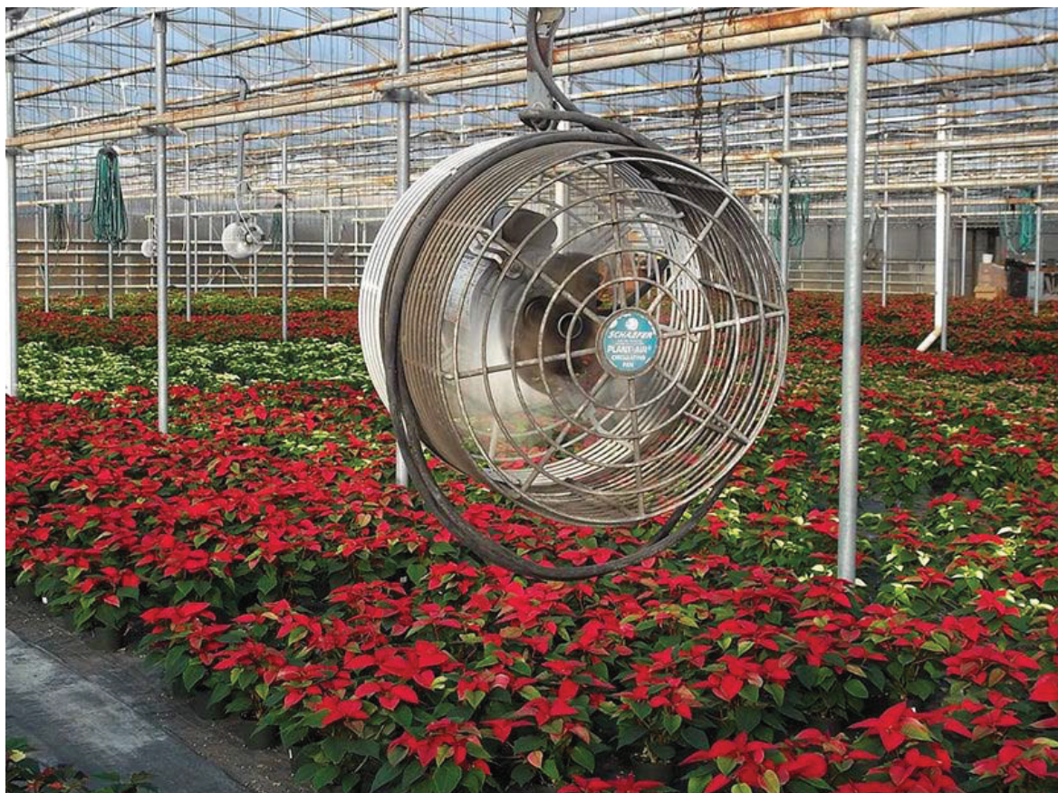
Εικόνα 9. Αξονικός ανεμιστήρας συστήματος ανακυκλοφορίας αέρα.
