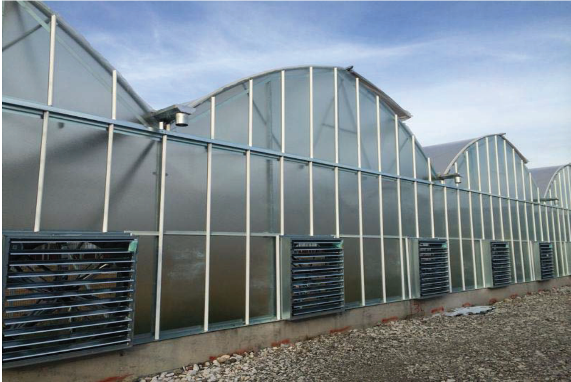
Εικόνα 8. Μεγάλοι ανεμιστήρες συστήματος εξαερισμού τοποθετημένοι στην πρόσοψη τροποποιημένου τοξωτού πολλαπλού θερμοκηπίου
