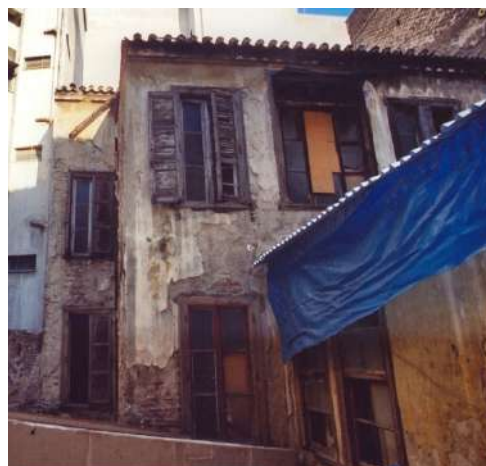
Εικόνα 2.12: Πίσω όψη του κτιρίου που βλέπει στον Ακάλυπτο χώρο. Είναι φανερό πως όλα τα φύλλα έχουν καθαιρεθεί λόγω μεγάλης φθοράς αλλά το πλαίσιο μαρτυρά ξεκάθαρα την ύπαρξη γερμανικού κουφώματος.
