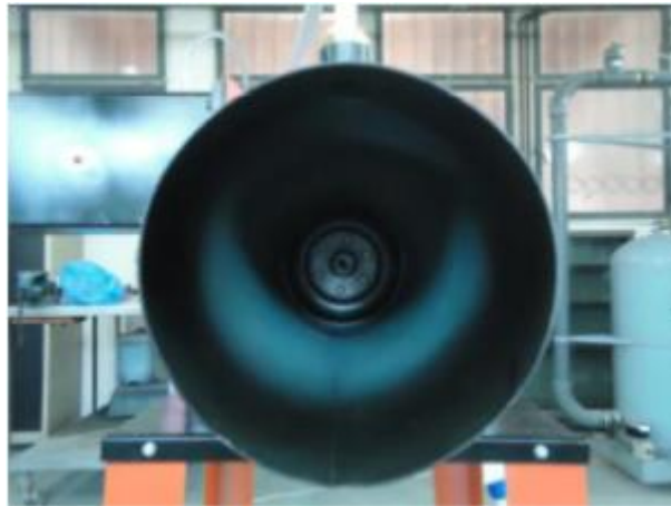
Εικόνα 18: Εσωτερικό αγωγού αναρρόφησης [9].
