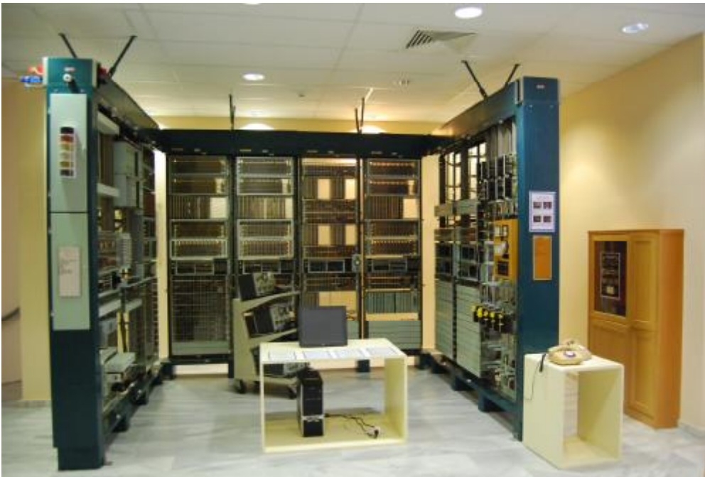
Εικόνα 21: Χώρος Τηλεφωνικού Κέντρου (Μουσείο Επιστημών και Τεχνολογίας)
