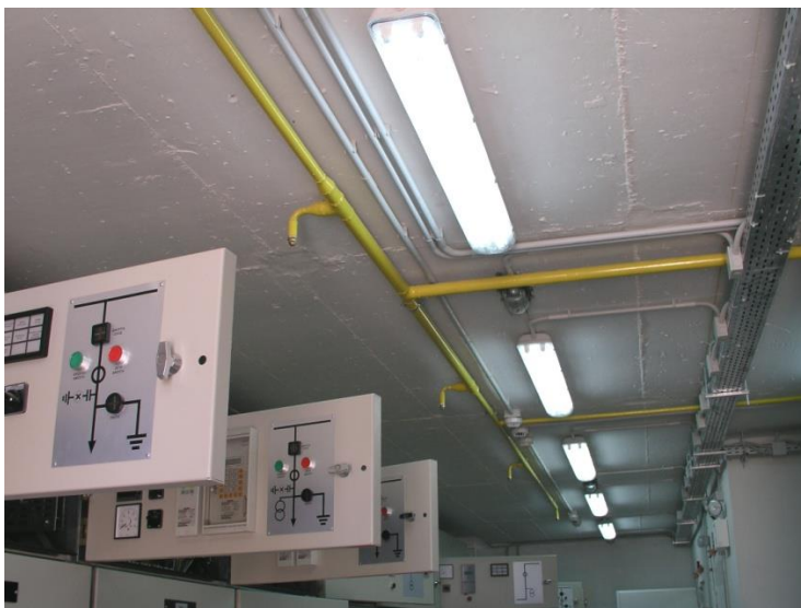
Εικόνα 20: Δίκτυο σωληνώσεων με ακροφύσια CO 2
