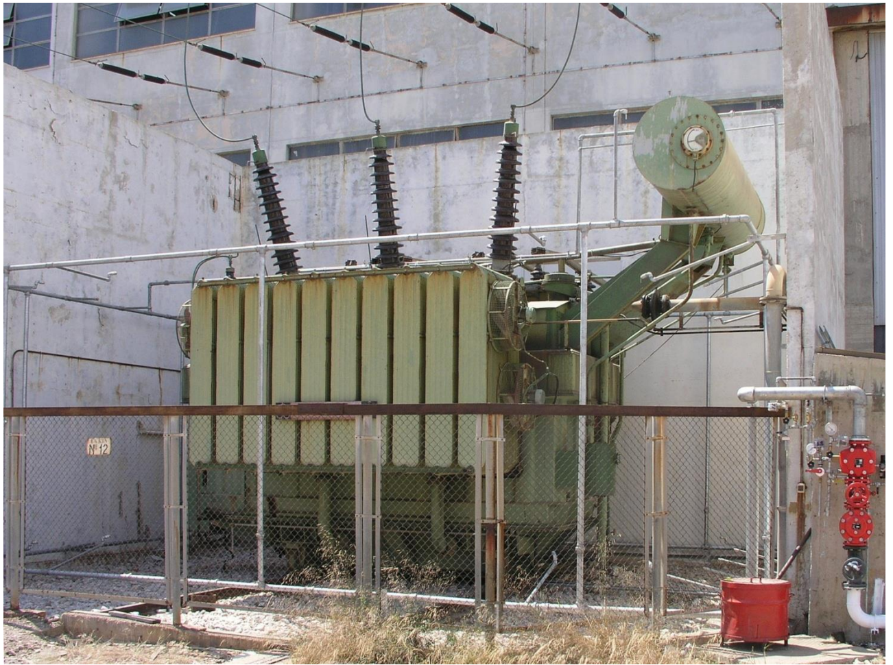
Εικόνα 12: Σύστημα πυρόσβεσης υπαίθριου μετασχηματιστή της ΔΕΗ στο Λαύριο με καταιονισμό νερού. Χρησιμοποιείται δίκτυο ξηρού τύπου και πυρανίχνευση με ιδιαίτερο δίκτυο πεπιεσμένου αέρα και sprinkler. Διακρίνεται η κεντρική βαλβίδα νερού (deluge)
