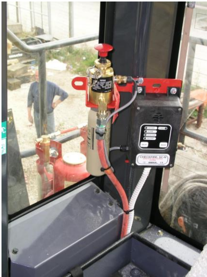
Εικόνα 25: Πίνακας ελέγχου και μονάδα χειροκίνητης-αυτόματης ενεργοποίησης στην καμπίνα οδηγού
