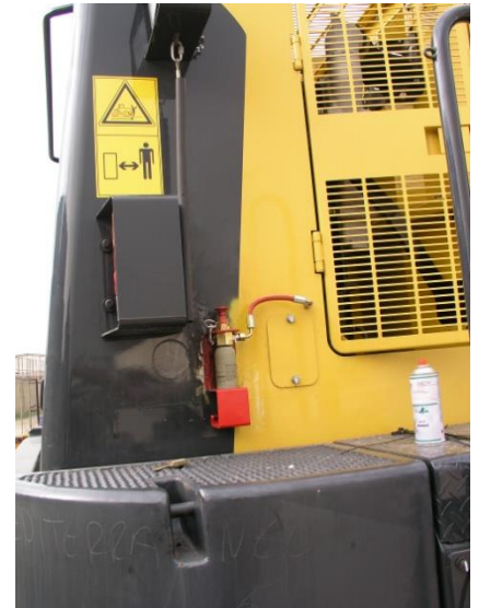
Εικόνα 27: Εξωτερική μονάδα χειροκίνητης ενεργοποίησης της πυρόσβεσης
