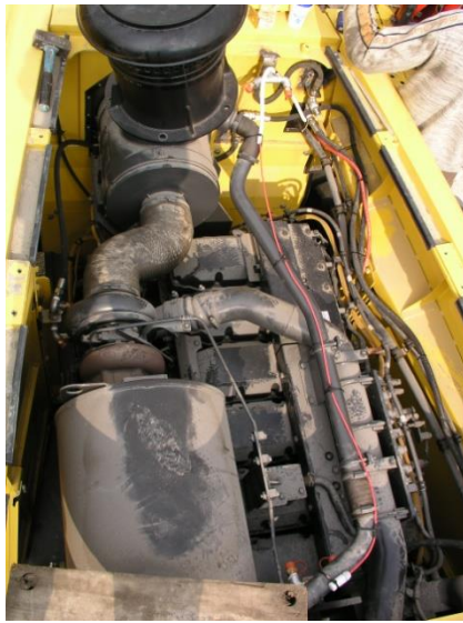
Εικόνα 28: Ακροφύσια και γραμμικός θερμικός ανιχνευτής στο διαμέρισμα κινητήρα
