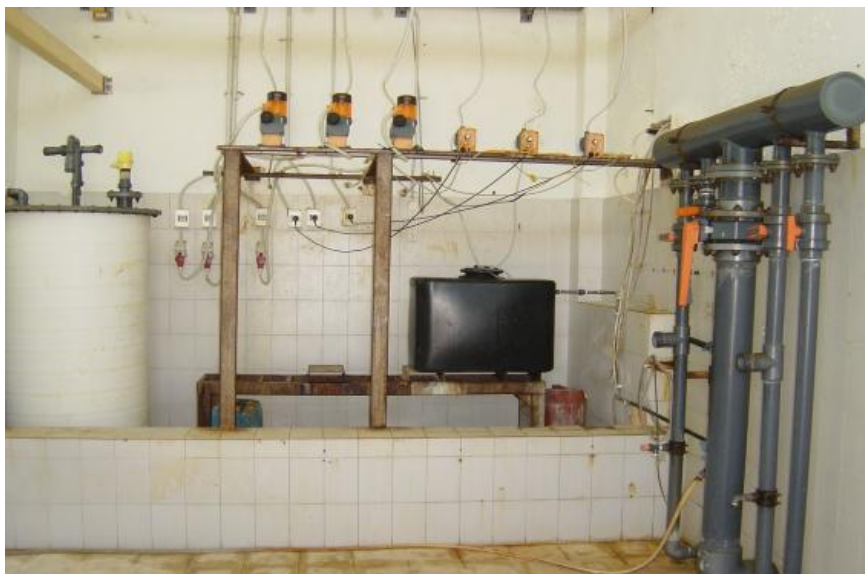
Εικόνα 21: Τροφοδοσία αντιδραστήρων εγκαταστάσεων Ριγανόκαμπου [14]
