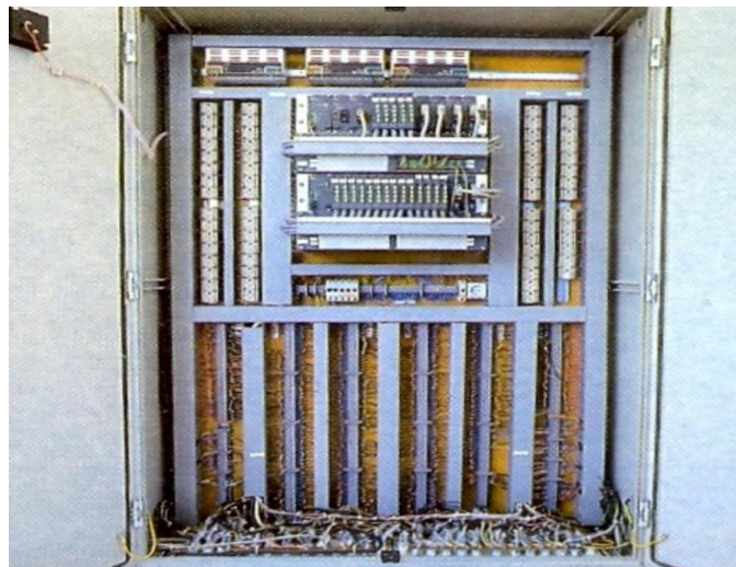
Εικόνα 24: Πίνακας Αυτοματισμού εγκαταστάσεων Ριγανόκαμπτου [14].
