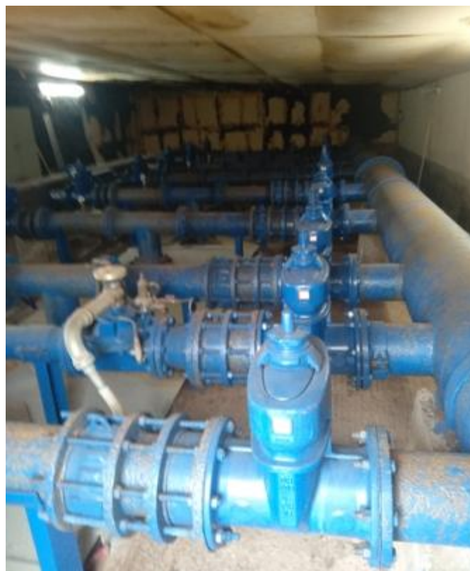
Εικόνα 31: Εσωτερικοί αγωγοί διυλιστηρίου της περιοχής Ταραμπούρα
