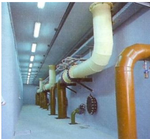
Εικόνα 16: Θάλαμος δικλίδων τροφοδοσίας διύλισης και απαγωγής ακαθάρτων Ριγανόκαμπου [14]
