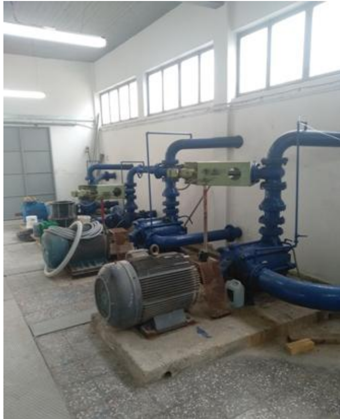
Εικόνα 30: Φυγοκεντρικές αντλίες αντλιοστασίου της περιοχής Ταραμούρα
