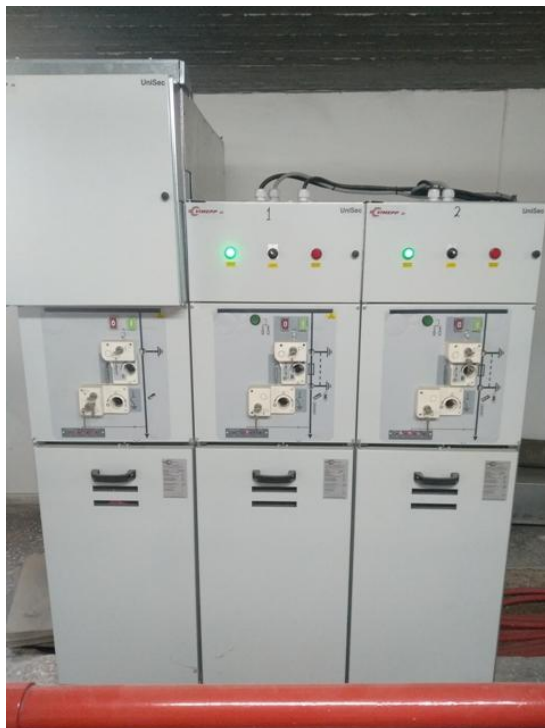
Εικόνα 32: Μονάδα ελέγχου διυλιστηρίων Ταραμπούρα
