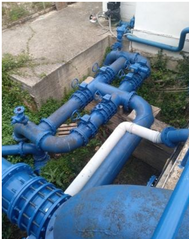
Εικόνα 29: Εξωτερικοί αγωγοί διυλιστηρίου Ταραμπούρα
