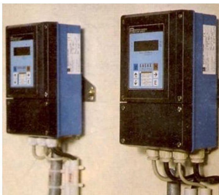
Εικόνα 22: Μετρητές ClO 2 εξόδου εγκαταστάσεων Ριγανόκαμπου [14].
