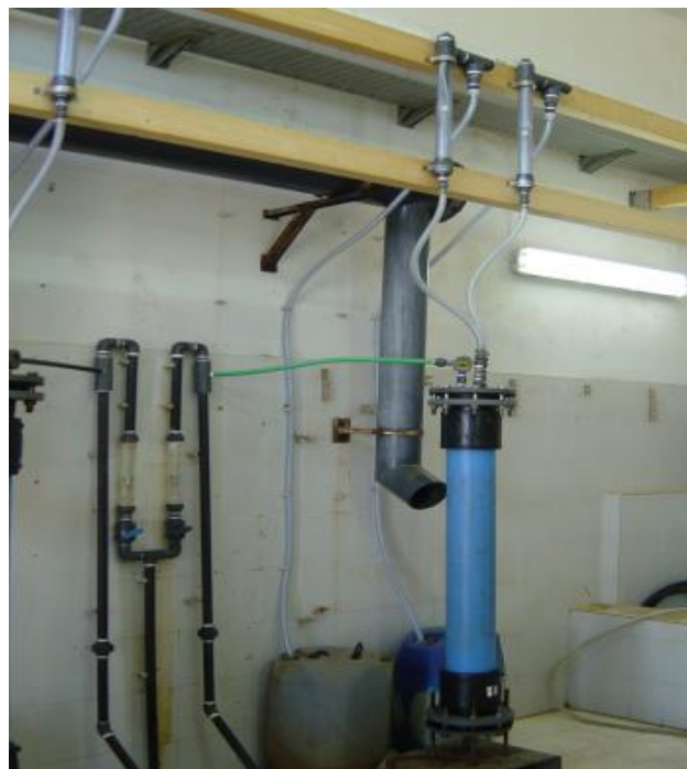
Εικόνα 20: Αντίδραστήρας \text{ClO}_2 εγκαταστάσεων Ριγανόκαμπου [14].
