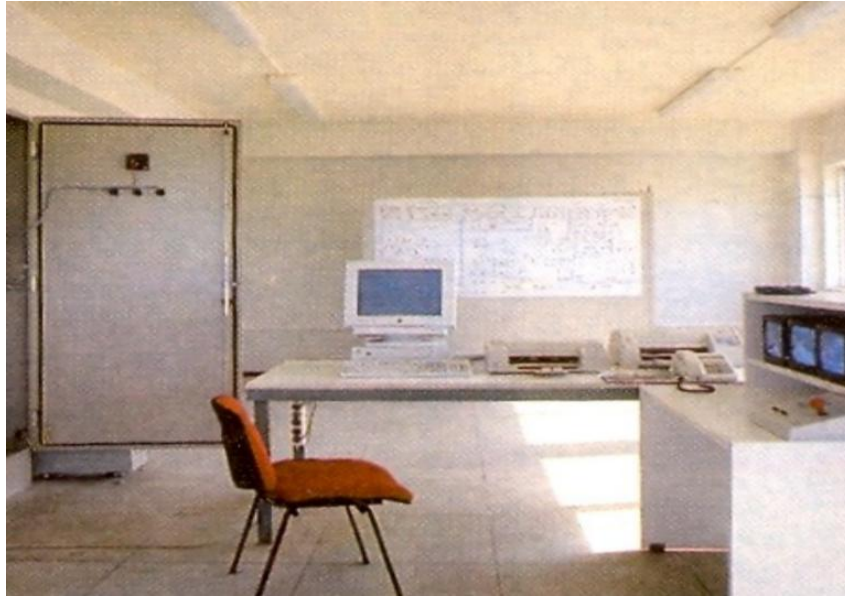
Εικόνα 25: Θάλαμος Ελέγχου εγκαταστάσεων Ριγανόκαμπου [14].
