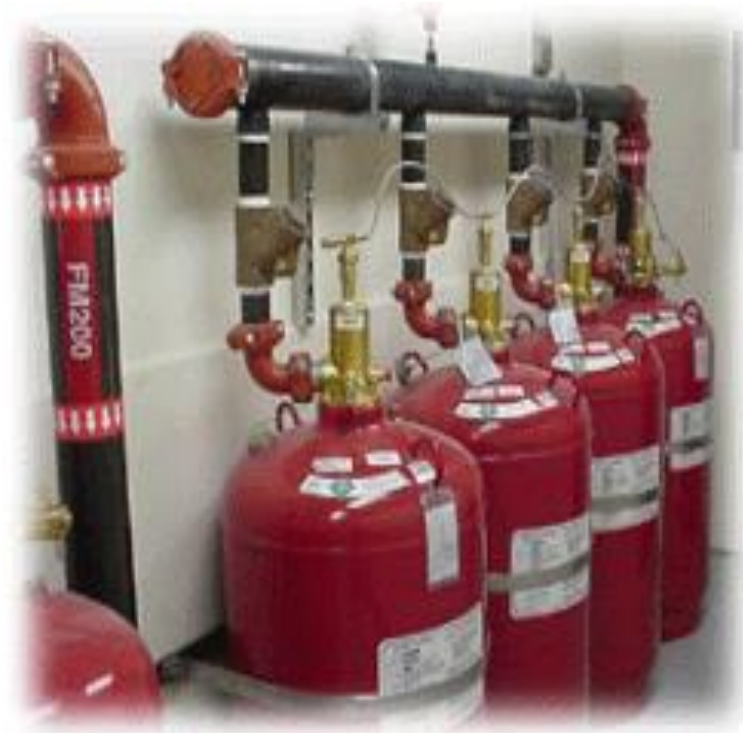
Εικόνα 3.8: Αυτόματο σύστημα πυρόσβεσης με ένα ή περισσότερα πυροσβεστικά δοχεία (Εταιρεία Fire Security)
