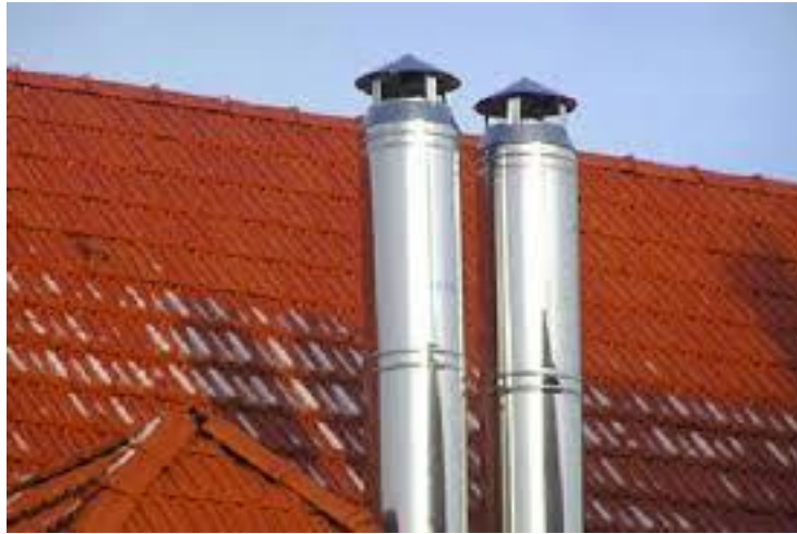
Εικόνα 3.19: Συνίσταται η κατακόρυφη τοποθέτηση της καπνοδόχου σε ένα σπίτι (Ομιλος Τσεκούρας)
