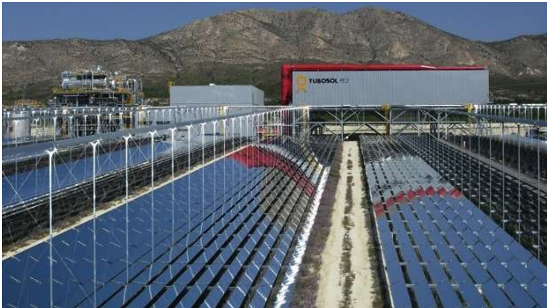
Σχήμα 2.4: Γραμμικοί συλλέκτες Fresnel. 43 (πηγή: Novatec Solar / Wikimedia Commons).
