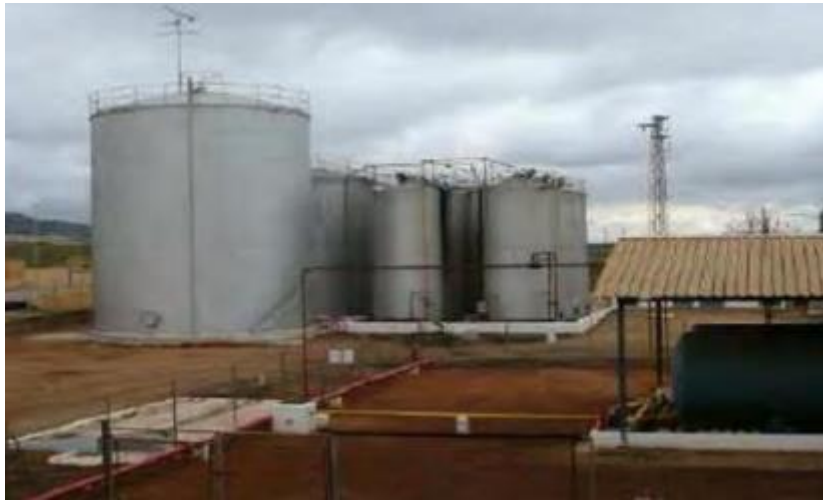
Εικόνα 7: Δεξαμενές αποθήκευσης πυρηνελαίου [24]
