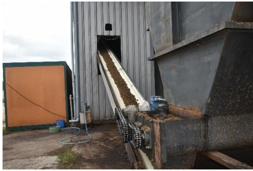
Τροφοδοσία νωπού ελαιοπυρήνα (εξωτερικά)
