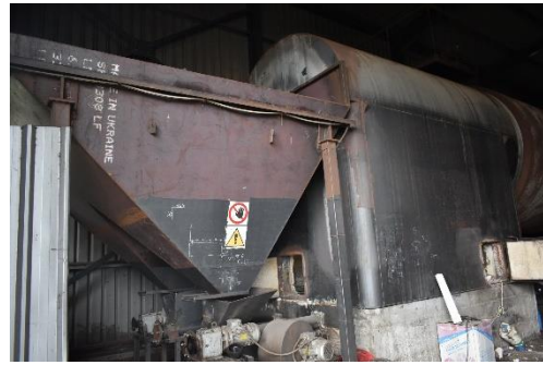
Τροφοδοσία νωπού ελαιοπυρήνα (εσωτερικά)
