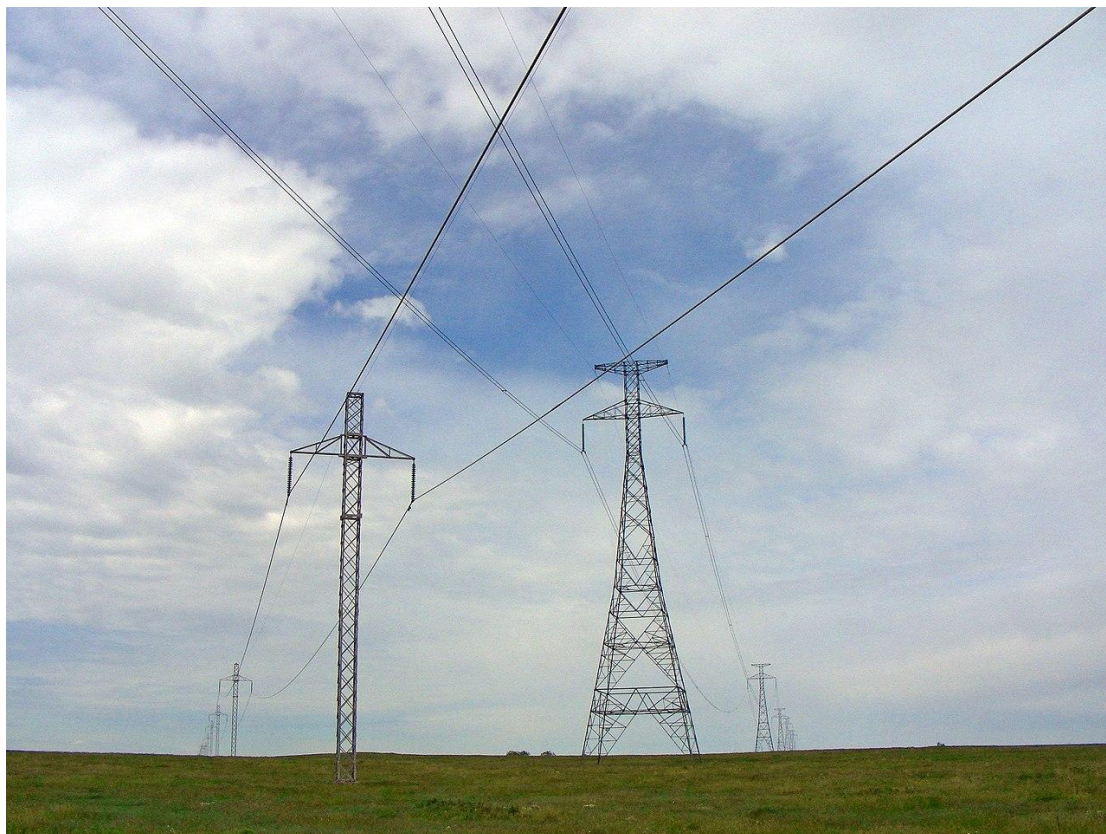
Εικόνα 5.1 Γραμμή μεταφοράς υψηλής τάσης σε ένα υπερπλέγμα μεταφοράς ηλεκτρικής ενέργειας [11].
