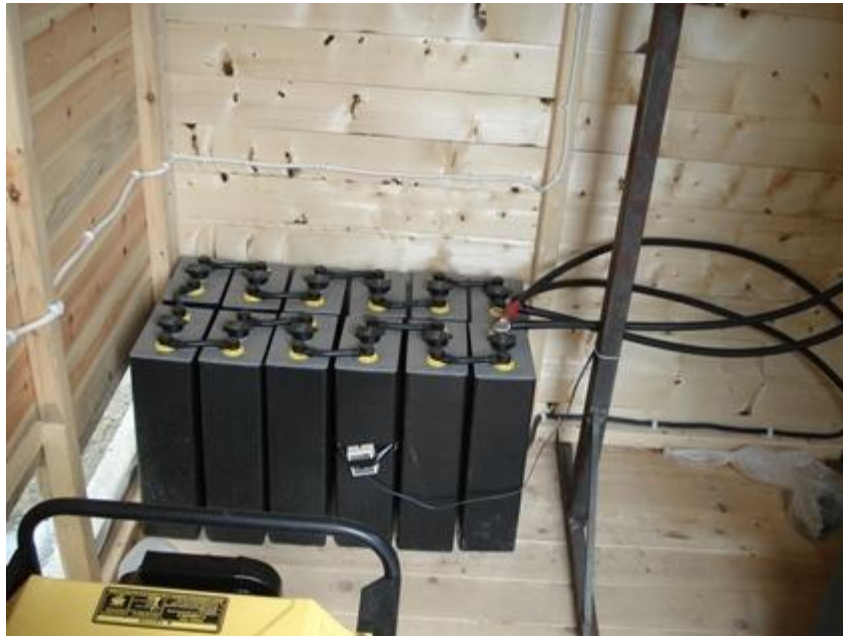
Εικόνα 3-4 2V Batteries OPzV σε αυτόνομο φωτοβολταϊκό σύστημα με γεννήτρια
