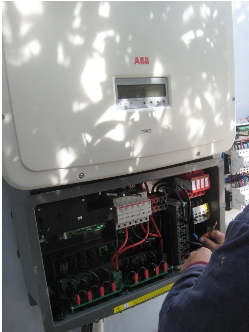
Εικόνα 4-6 Οι καλωδιώσεις σύνδεσης του inverter
