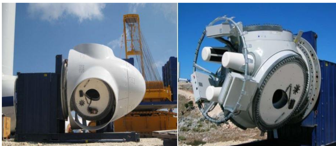
Εικόνα 17.Ρότορας ανεμογεννήτριας. Πηγή
