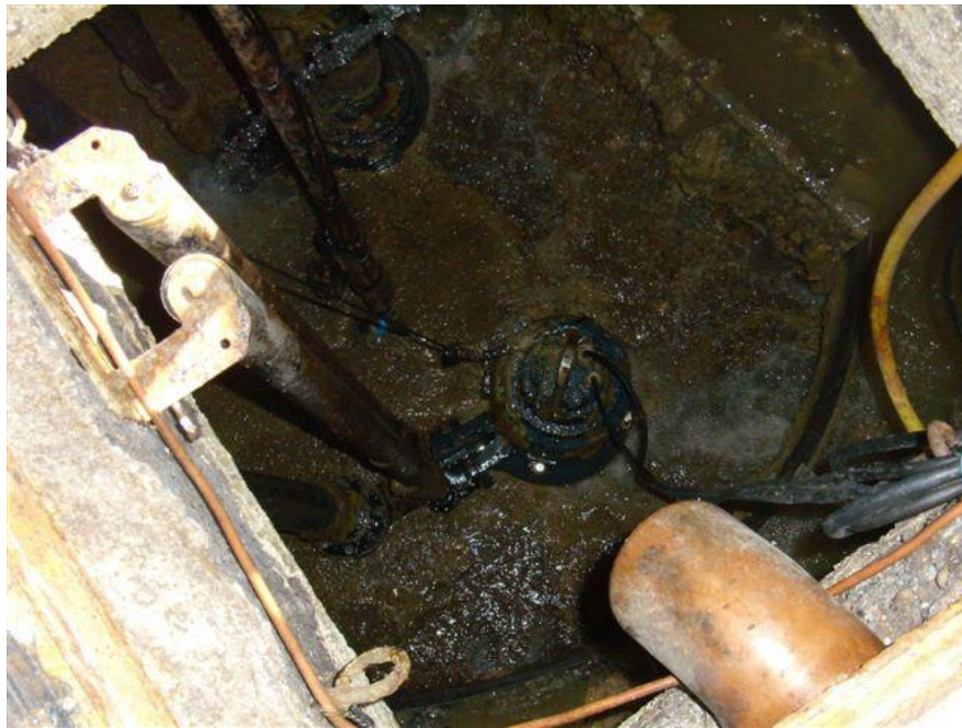
Εικόνα 23: Αντλιοστάσιο λυμάτων στην Σαντορίνη.[Διαδίκτυο 23]
