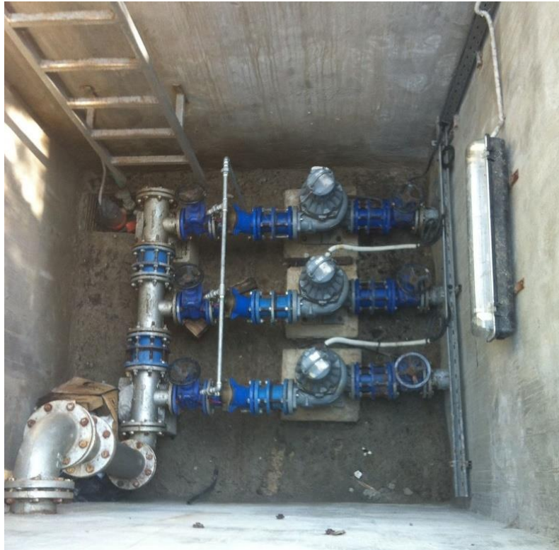
Εικόνα 24: Κεντρικό αντλιοστάσιο λυμάτων με τρεις αντλίες [Διαδίκτυο 24]
